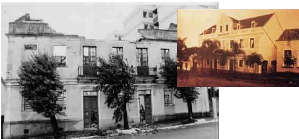
FIGURA 34 – ANTIGA FUNDAÇÃO EVANGÉLICA O STIFT – FUNDAÇÃO CIDADE DO MENOR SÃO JOAO BOSCO 115 FONTE: Foto detalhe, do acervo da Fundação Scheffel. Data: s.d. Foto maior, logo após o incêndio, acervo Andreas Grings. Data: 1999.
