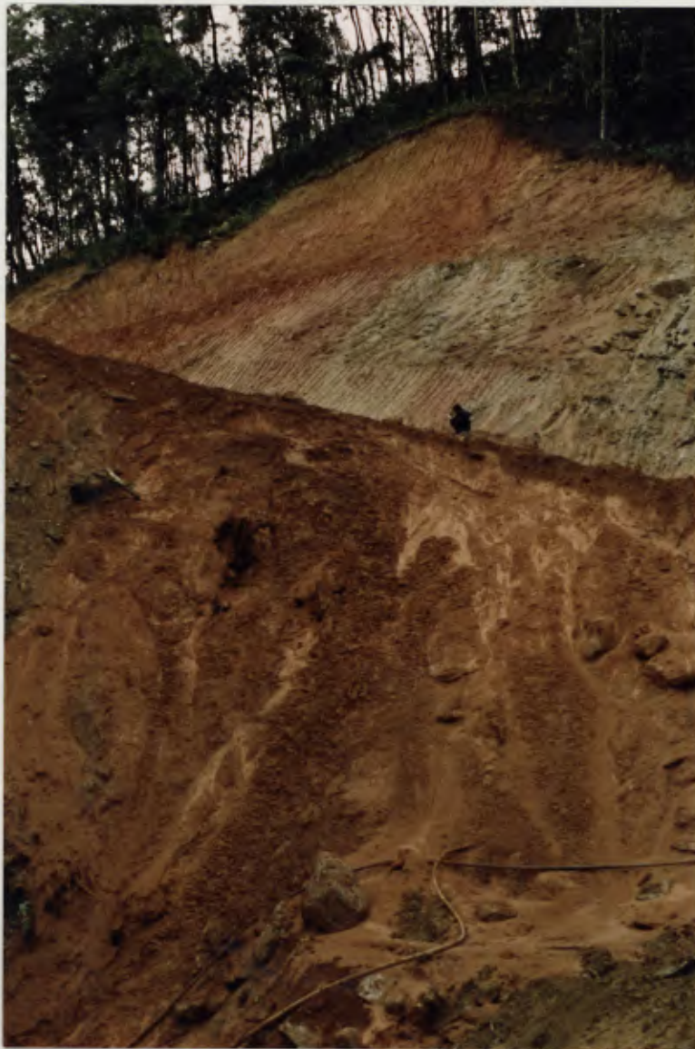
Foto nº 7 - Rampa de alta inclinação, em situação crítica. Percebe-se as tu bulações utilizadas na drenagem do curso d'agua' aterrado (pontos c e d)
