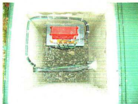
Transformador 380V para 12V das luminárias
