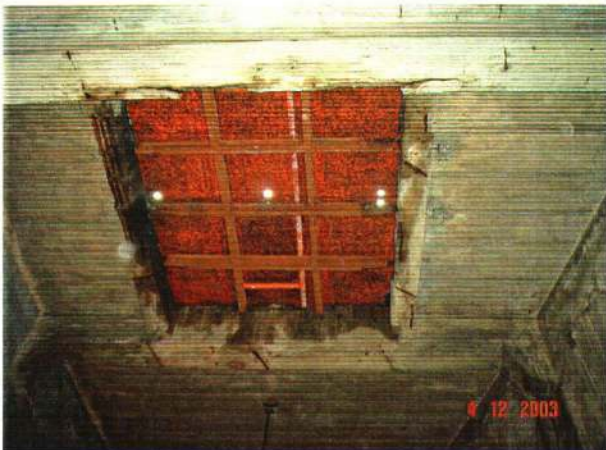
Alçapão para manutenção do reservatório superior
