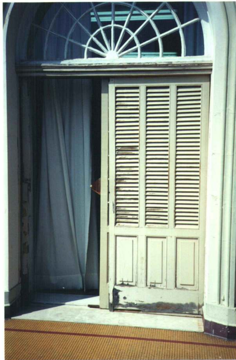
DETALHE DO APODRECIMENTO DA MADEIRA DA PORTA DE ACESSO AO TERRAÇO DO PAV. SUPERIOR
