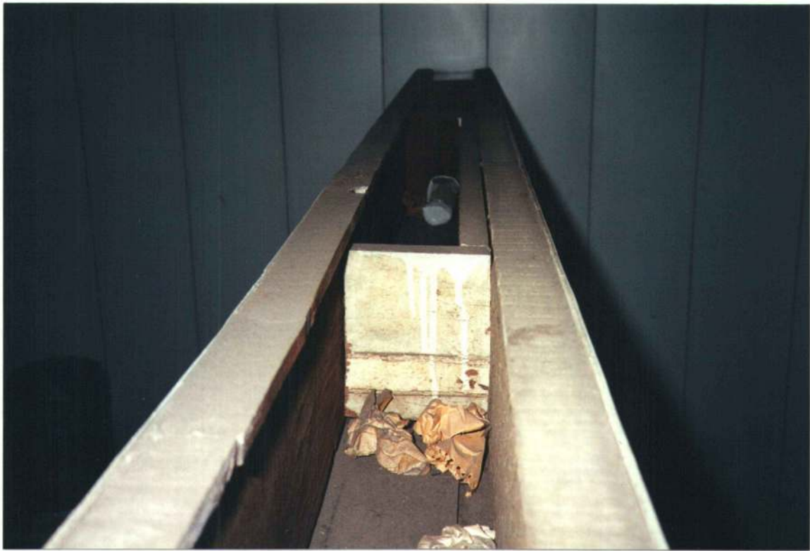
ACÚMULO DE LIXO NA PARTE SUPERIOR DE VIGAS DE TRAVAMENTO DE DIVISÓRIAS NO SOTÃO.
