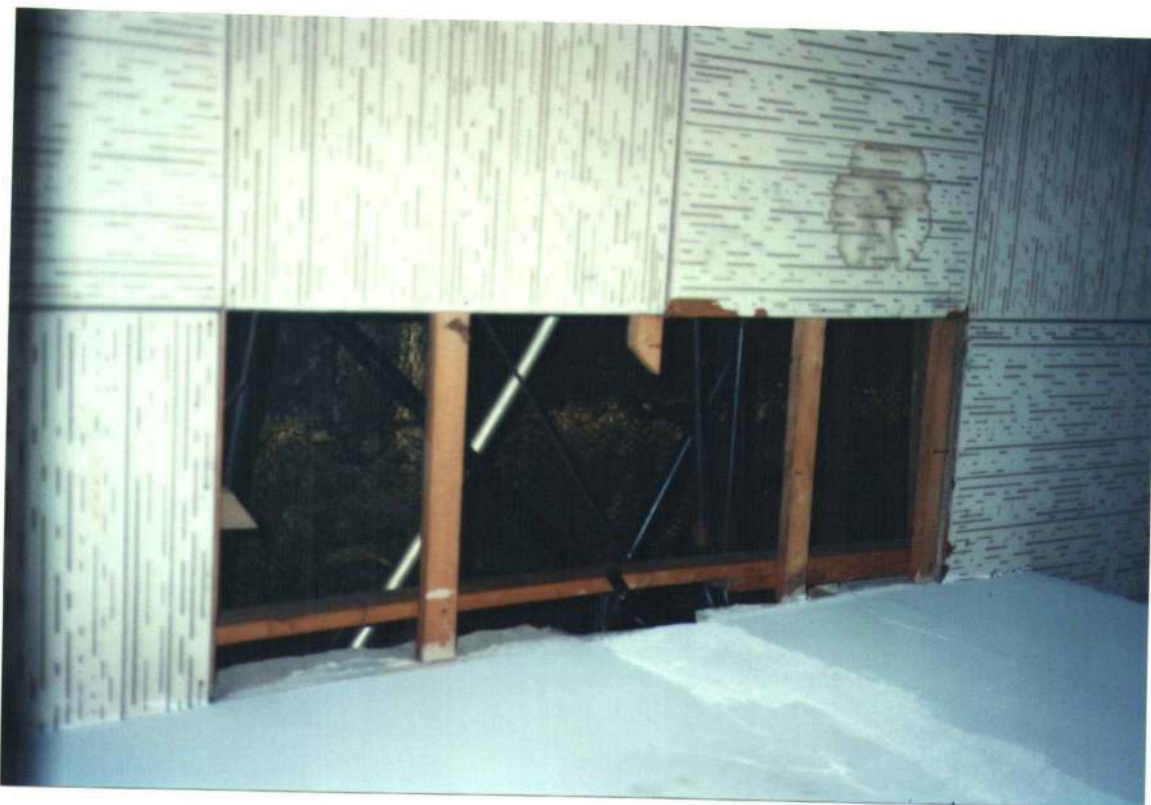
DESCOLAMENTO DE PLACAS DO FORRO DO SÓTÃO, DECORATIVAS DE INFILTRAÇÃO D'ÁGUA ATRAVÉS DA COBERTURA.
