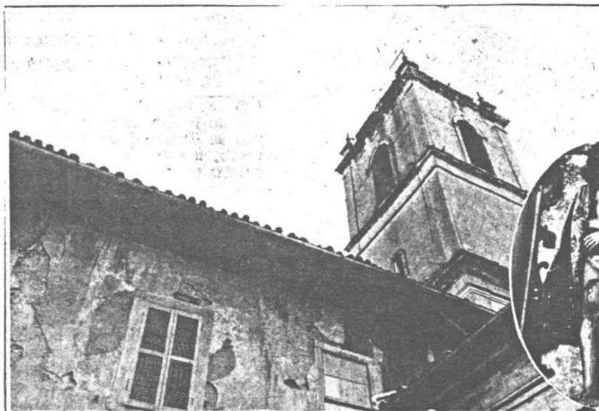
O teto da igreja ameaça desabar
