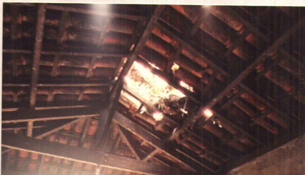
Foto 6 : Teto da garagem, com danos causados pela árvore que caiu.
