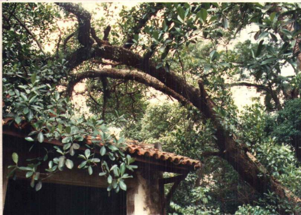
Foto 5 : Árvore caída na garagem.
