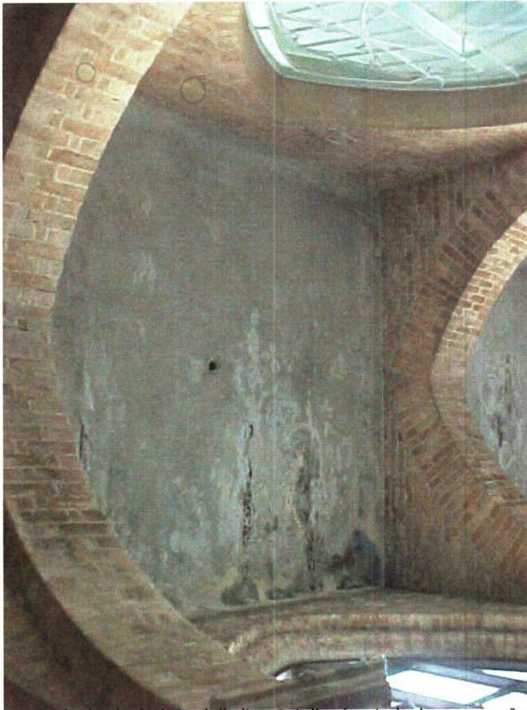
Laje circulação lateral direita - Detalhe do estado de conservação
