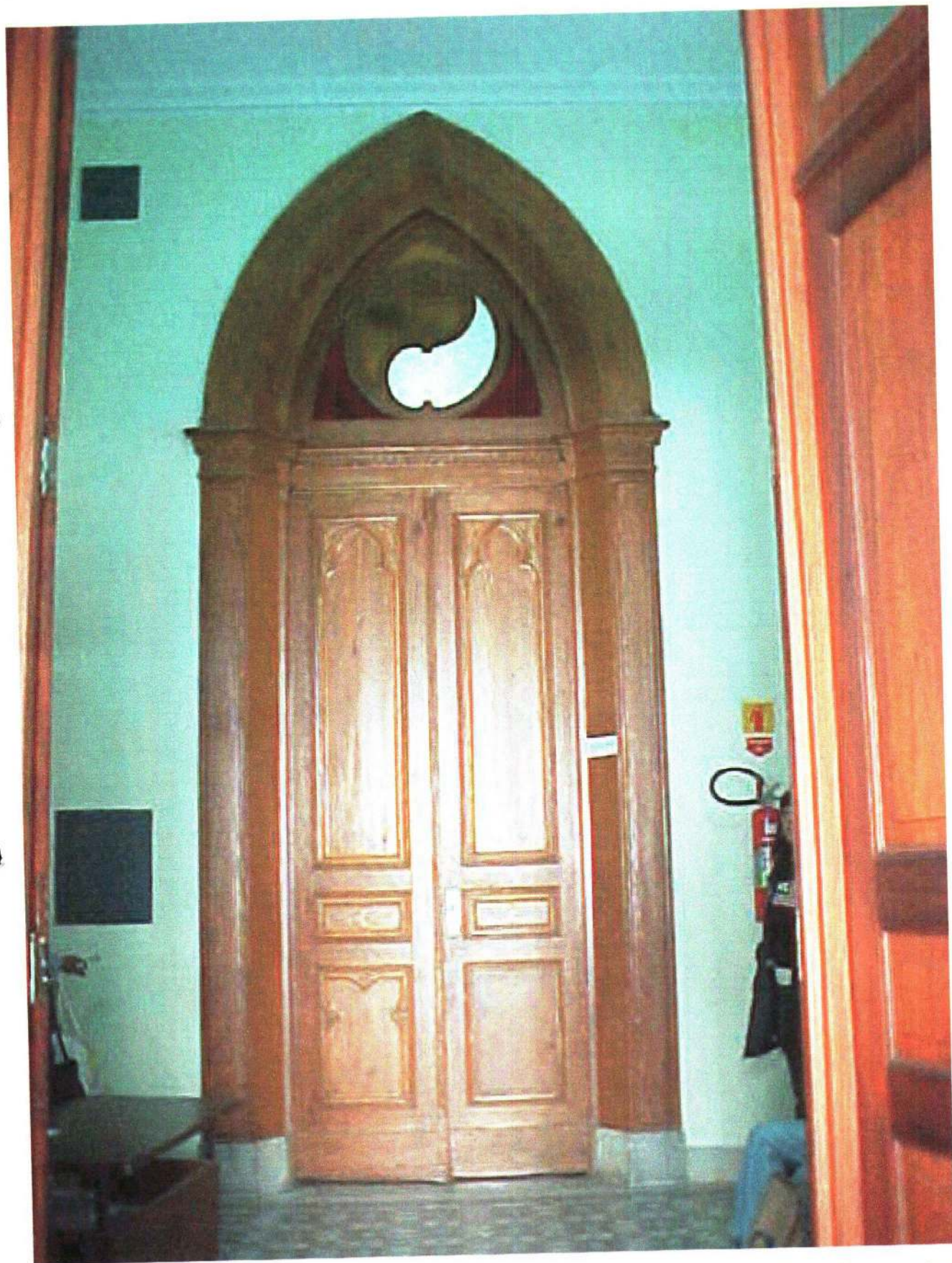
Porta em pinho de riga de acesso à enfermaria em bom estado de conservação - Construção original
