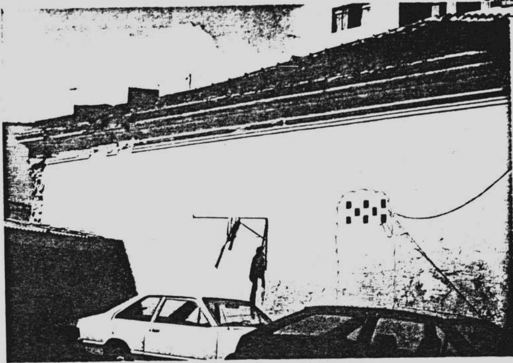
FACHADA POSTERIOR (OS TIJOLOS INTERCALADOS EVIDENCIAM JANELA EMPAREDADA)
