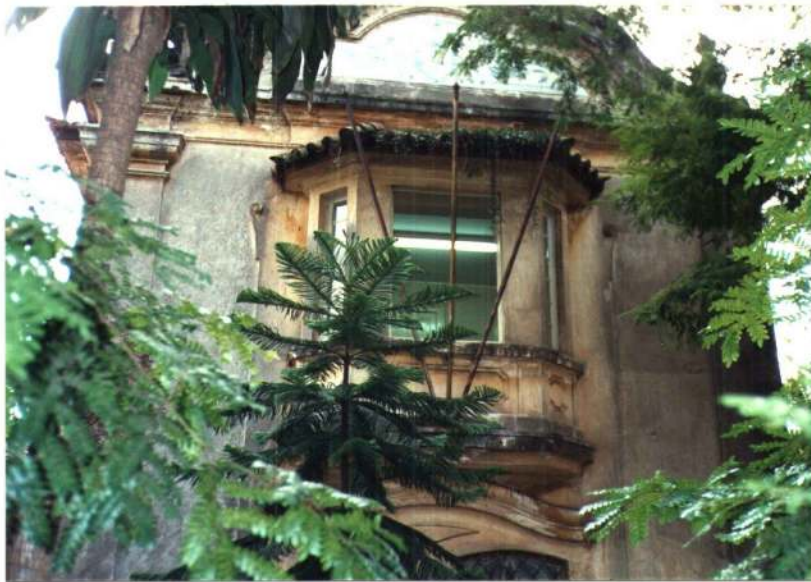
DETALHE GABINETE PRÉDIO REITORIA
