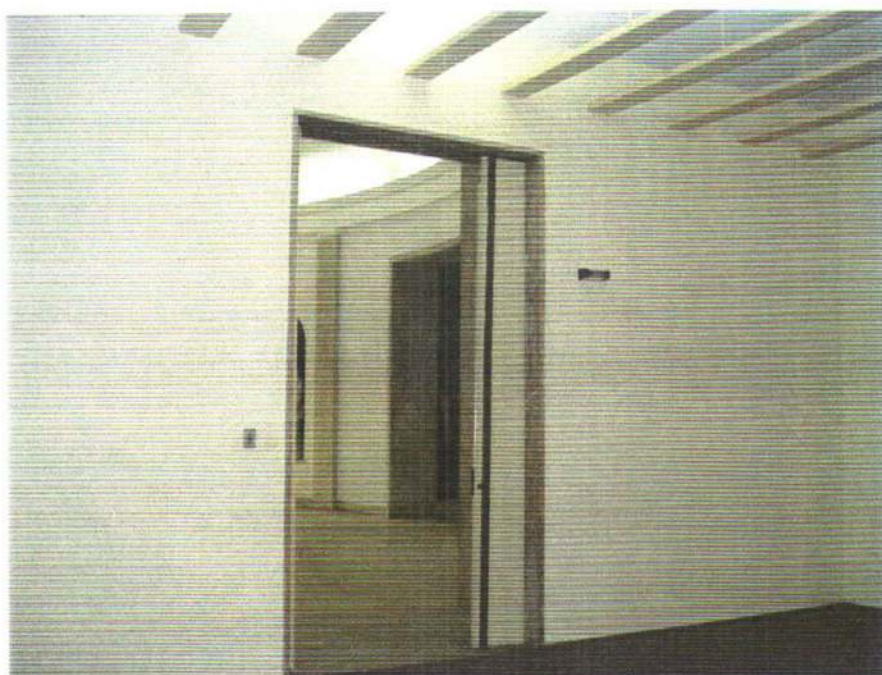
Porta da Galeria de acesso ao auditório, verso Átrio. data: 08.09.08 foto: Vanessa Kraml
