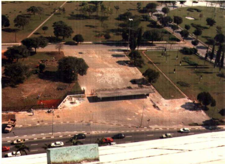
Entrada principal do Parque, hoje totalmente danificada em virtude das obras de construção do tunel.
