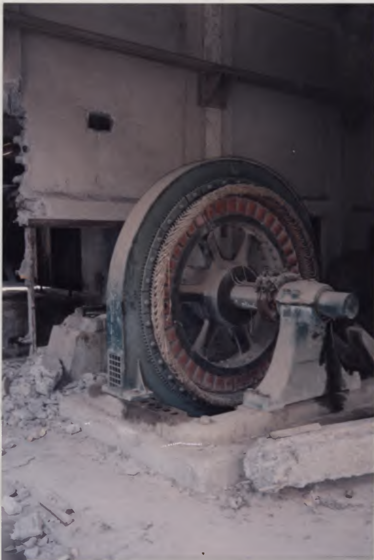
Foto 29: equipamento interno da área dos fornos
