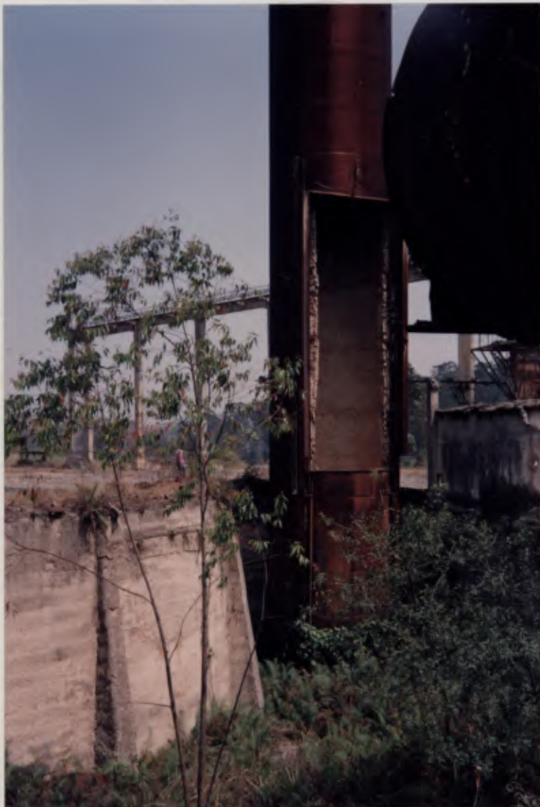
Foto 17: outra vista do forno. Foto 18: detalhe da parte interna do forno.
