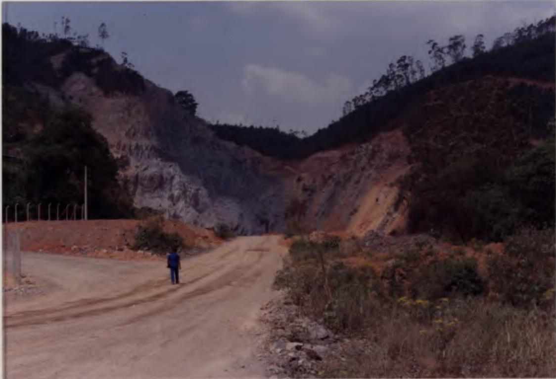
Foto 42: lavra iniciada em área envoltória e sem autorização do Condephaat.
