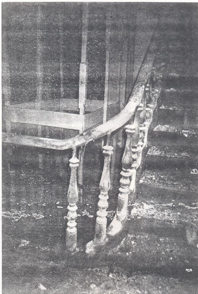
BALAUSTRÉS FALTANTES (2º PISO)
