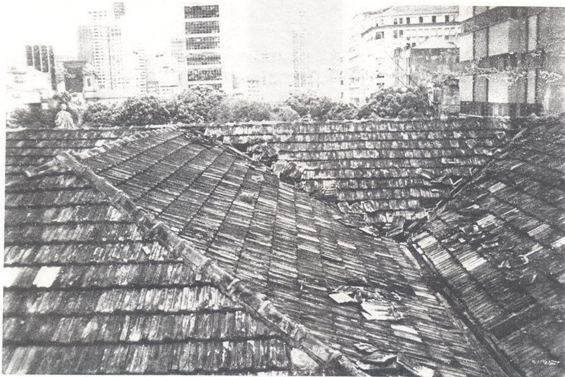
INEXISTÊNCIA DE CALHAS E RINCÕES
