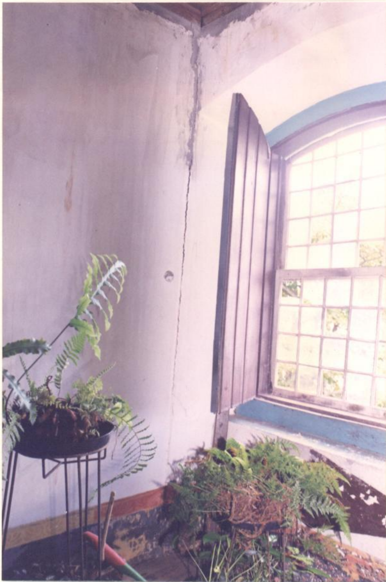
12 - Sala (com rachadura na parede).
