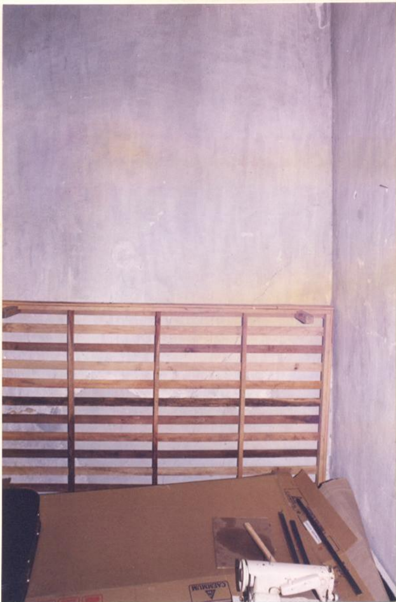
8 - Comodo interno com rachadura
