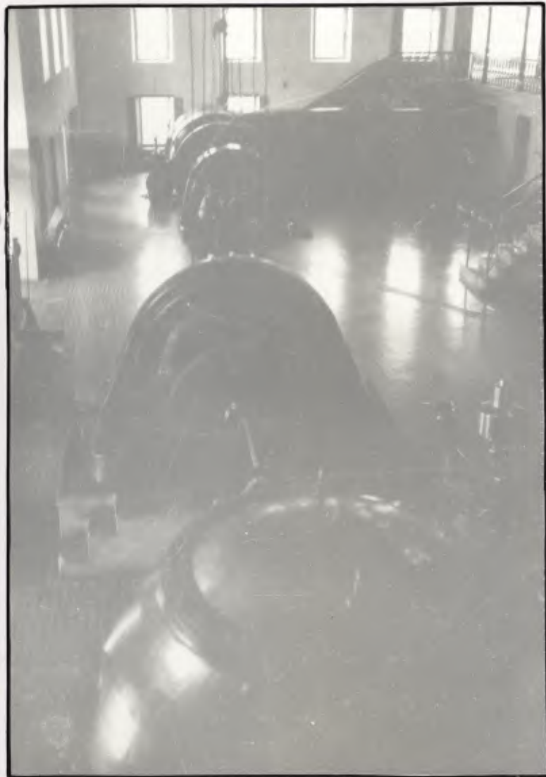
VISTA INTERNA - CASA DAS MÁQUINAS
