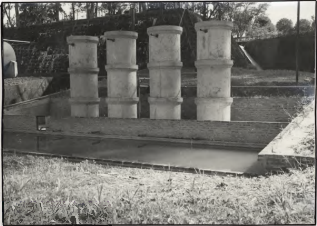
FILTRO E DEPÓSITO D'AGUA
