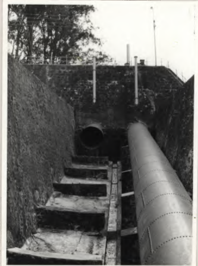
Tubo de canalização forçada da câmara para casa das máquinas.
