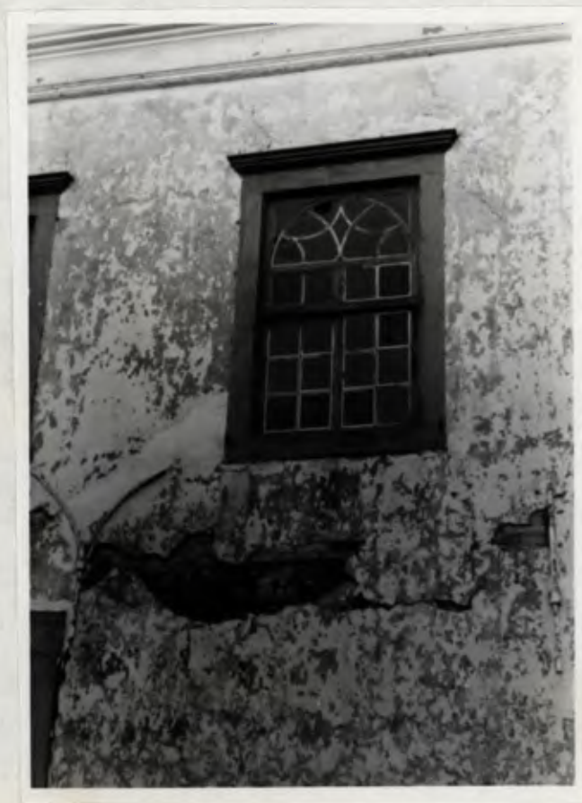
Rachadura na parede de taipa.
