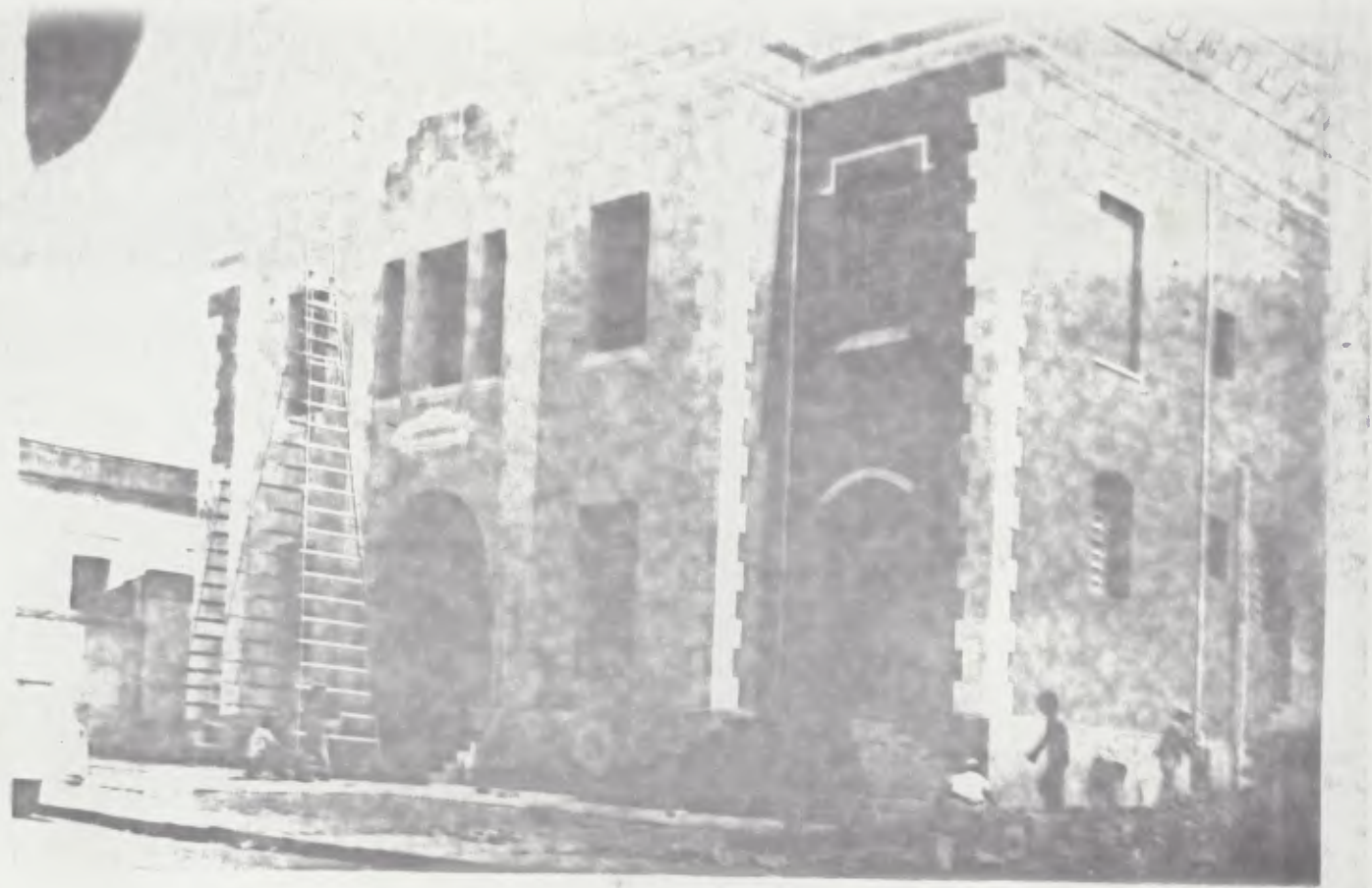
PRÉDIO DA ANTIGA CADEIA E FORUM DE S. JOSE' DO RIO PARDO, SITO A Pça. DR. CÂNDIDO RODRIGUES, EM FASE DE REFORMA. SERÁ O FUTURO MUSEU DA CIDADE, PROVAVELMENTE RECEBENDO ONOME DE "EUCLIDES DA CUNHA"
