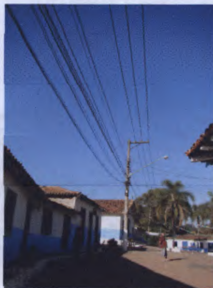
Foto 8: Fiação da rede elétrica da Aldeia de Carapicuíba.
