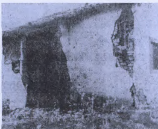
Foto 20: Casa secular em péssimo estado de conservação. Aldeia de Carapicuíba, SP, 1979.
