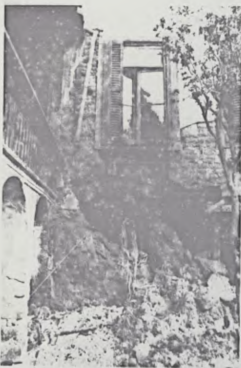
FOTO Nº 2: Desabamento parcial da taipa na parte posterior da casa. Iniciado no porão compromete atualmente o pavimento superior.
