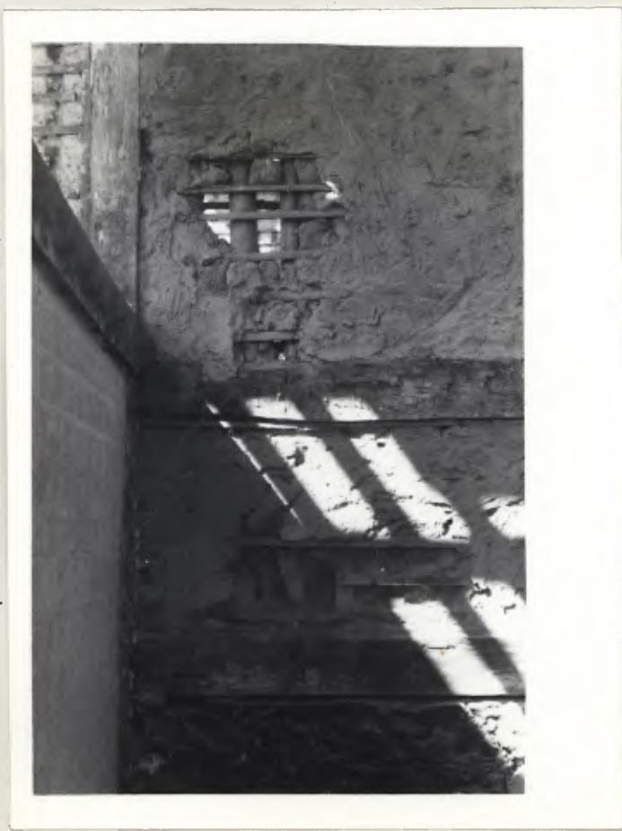
Parede de vedação interna, vendo-se trama do pau-a-pique original. Esta "janela" será mantida, sendo fixado lâmina de vidro para exposição da Técnica construtiva original.
