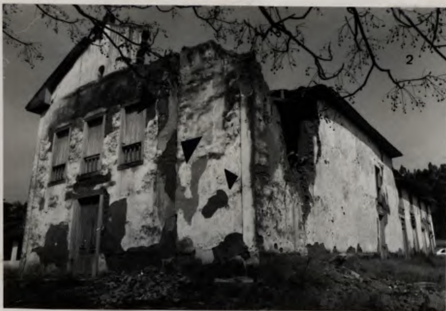
2. Trinca Juntas entre Setor Original e Acréscimo
