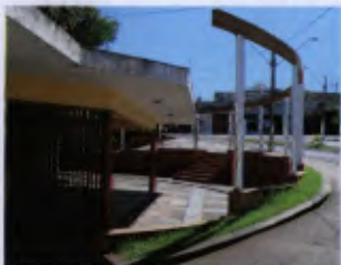
Face sudoeste: anexo construído e que se sugere demolição para recomposição da fachada original
