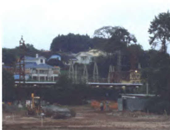
Autor: Arq. José Antonio C. Zagato Foto realizada em 15.01.2010 Vista geral da terraplanagem, com estação e plataformas ao fundo
