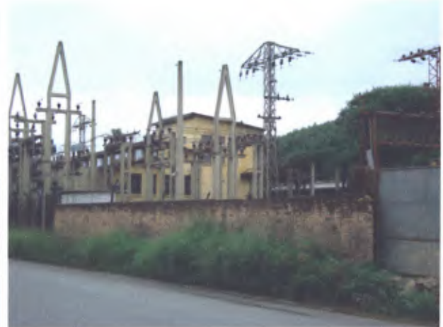
Área envoltória (Art. 4º inciso VI) Subestação elétrica
