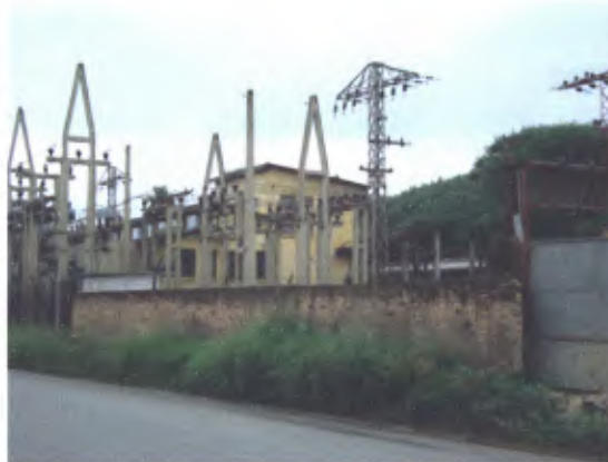
Autor: Arq. José Antonio C. Zagato Foto realizada em 15.01.2010 Subestação elétrica: local previsto de passagem do viaduto (Vista sul)
