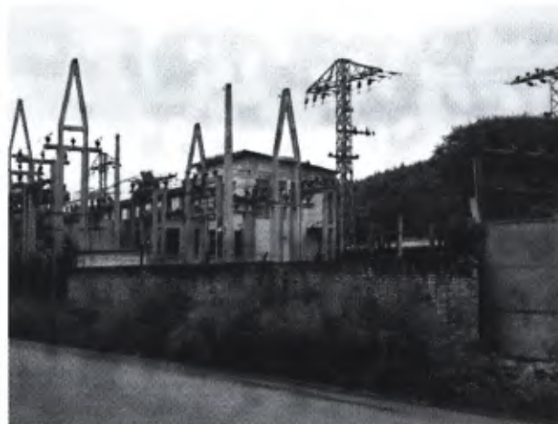
Área envoltória (Art. 4º inciso II) Subestação elétrica
