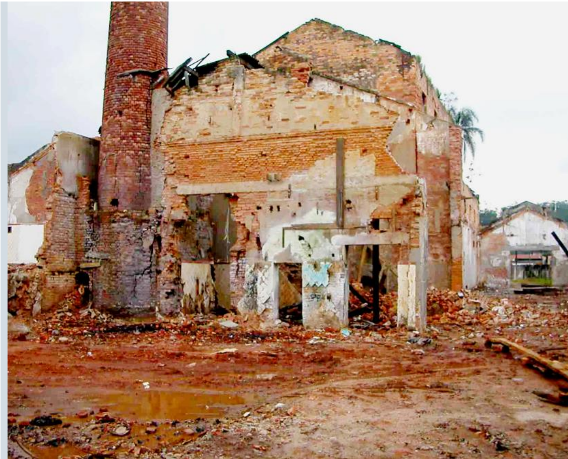
Figura 36: Foto mostra paredes construídas ao redor da chaminé, com rachaduras e fora do prumo, 2004. Foto cedida por Perrone e Associados.
