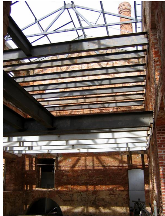
Figura 27: Em outro ângulo, vigas que dão suporte ao pavimento superior encontram-se firmes após 11 anos da inauguração, 2004. Foto cedida por Perrone e Associados.
