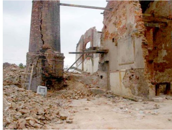
Figura 24: Rachadura aparente na chaminé que comprometia sua estabilidade foi sanada e permanece em pé até os dias atuais, 2004. Foto cedida por Perrone e Associados.
