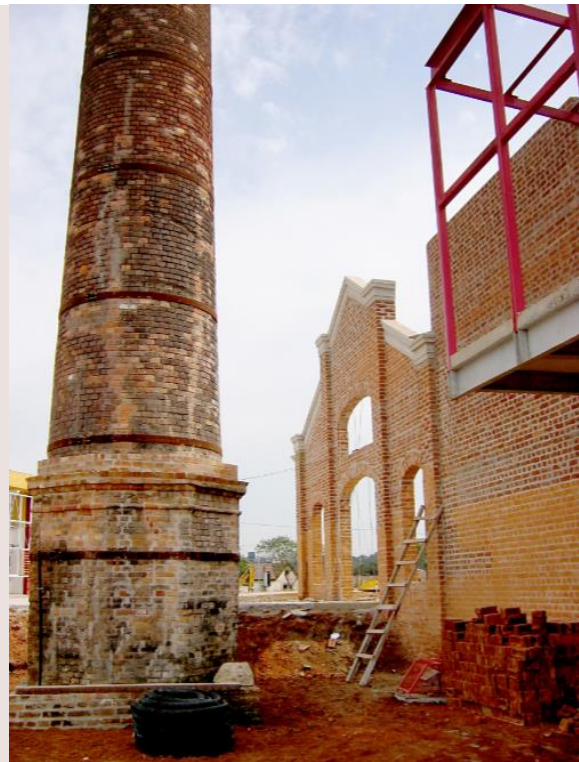
Figura 35: Base octogonal (forno) revelada após escavações e recuperada, 2004. O cintamento em aço platinado revela que a recuperação foi cercada de cuidados. Foto cedida por Perrone e Associados.
