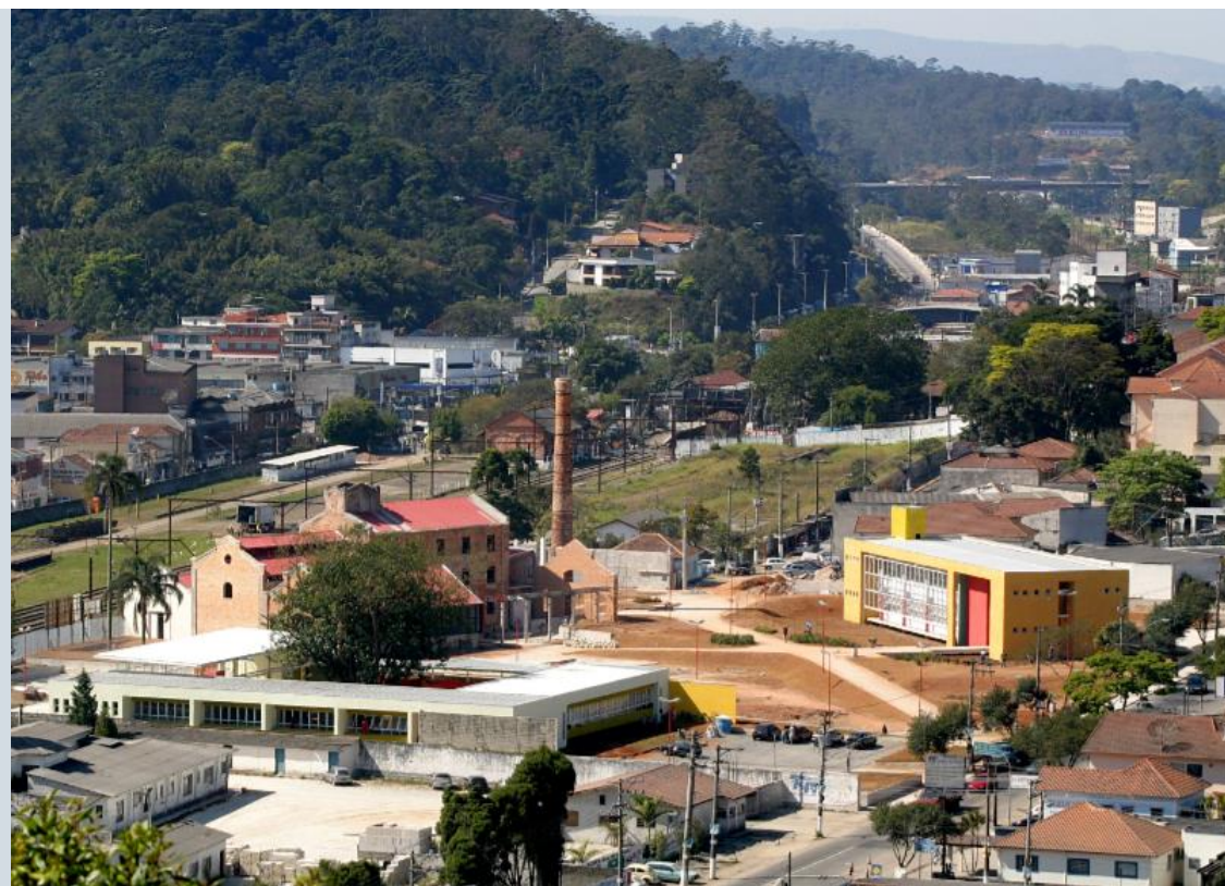
Figura 37: Vista aérea do canteiro de obras, 2004. Foto cedida por Perrone e Associados.
