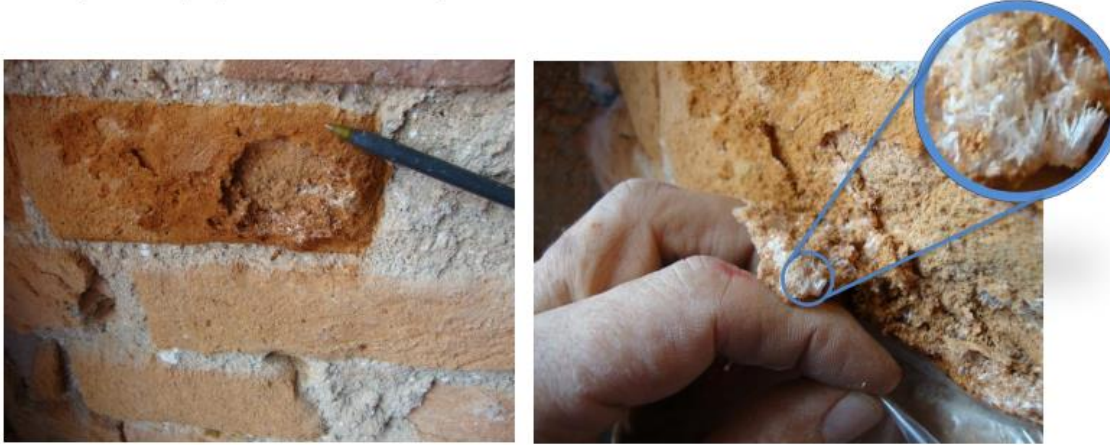
Figura mostra delaminação dos tijolos e criptoflorescência (surgimento de cristais de cloreto de sódio)
