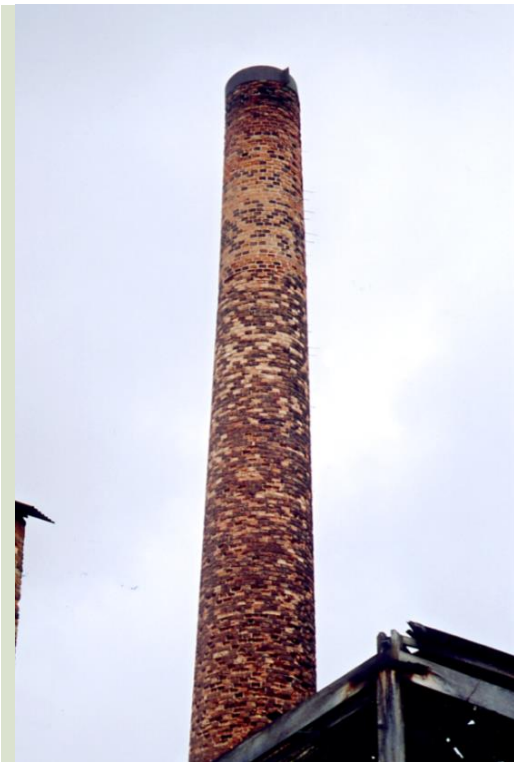
Figura 34: Foto do alto da chaminé sem o coroamento típico da arquitetura fabril do final do século XIX, que foi restaurada em 2004. Foto cedida por Perrone e Associados.
