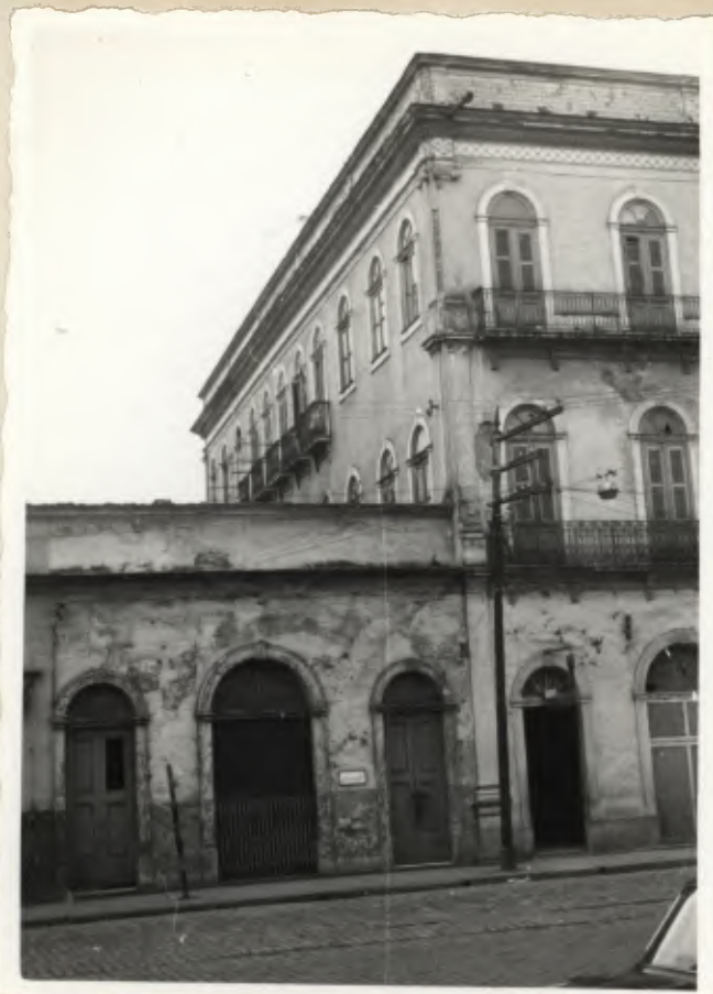
Parte da fachada dianteira ainda com características originais. Note-se os azulejos das platibandas e os vidros nas janelas e bandeiras.
