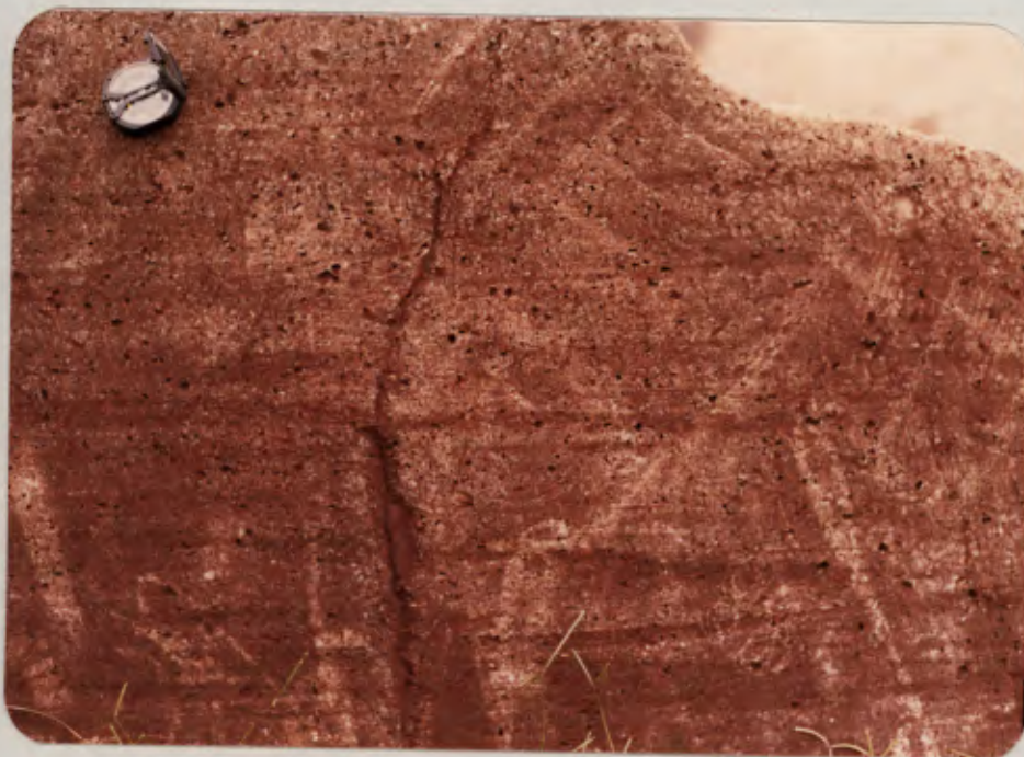
Foto 3 - Detalhe da foto acima. Note-se a fratura.
