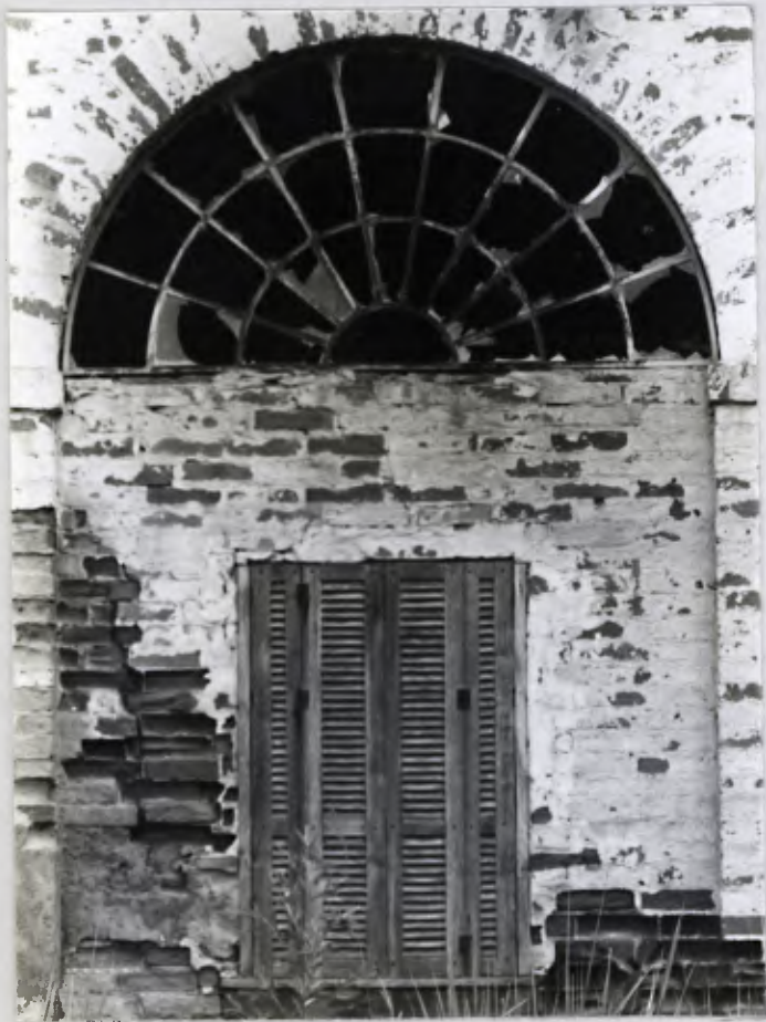
Detalhe de janela descaracterizada
