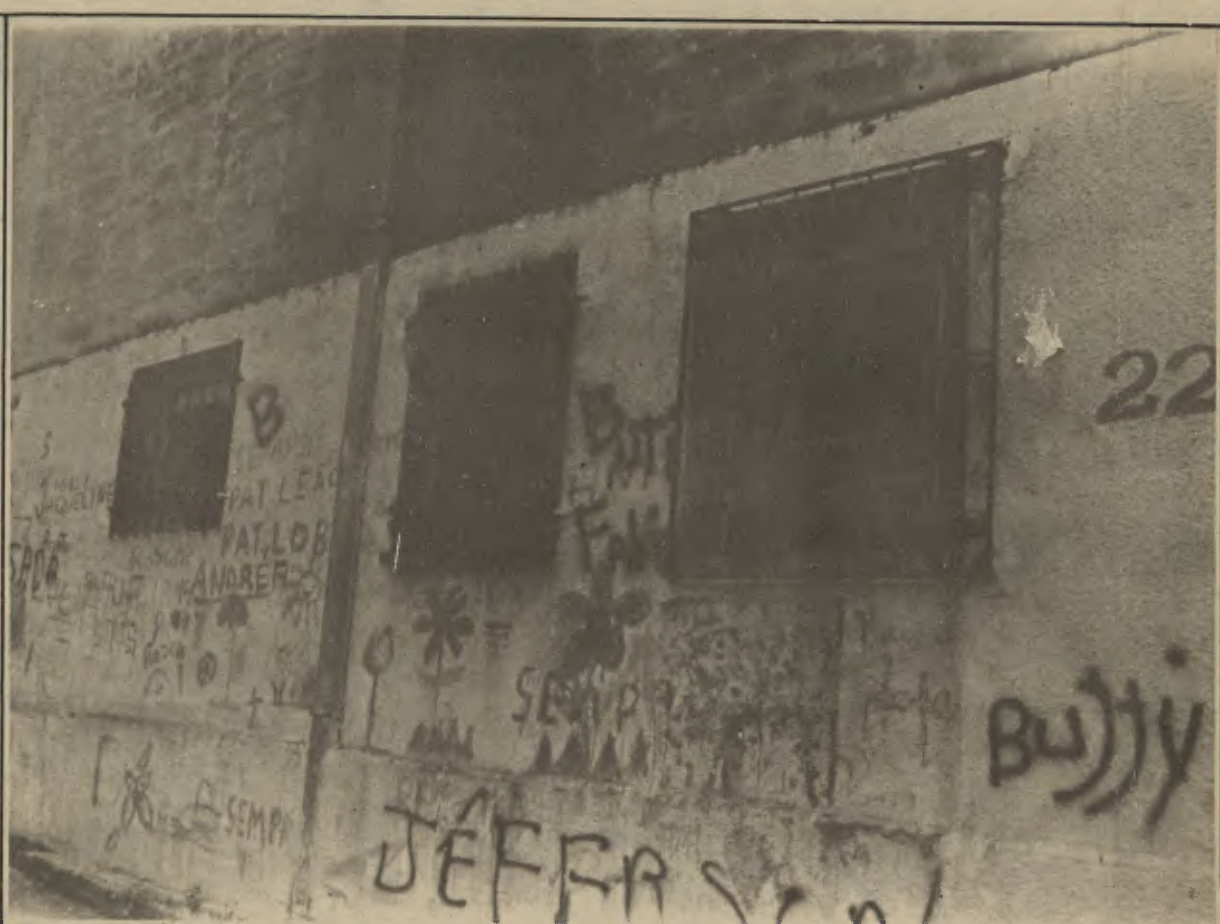
O mal estado de conservação, apesar das qualidades.
