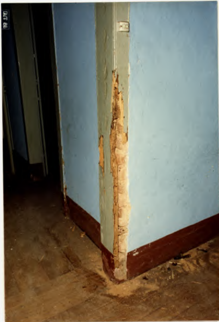
O Cupim está comendo todo o madeiramento, inclusive das portas e teto.
