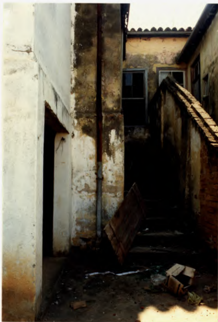
Os vizinhos estão fazendo de depósito de lixo.
