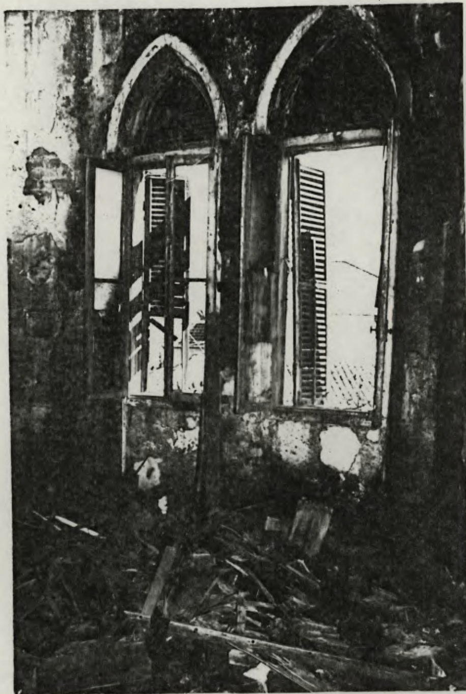
FOTO 27 - Vista interna das janelas do aposento voltado para a fachada oeste. Note-se em destaque os arcos ogivais.
