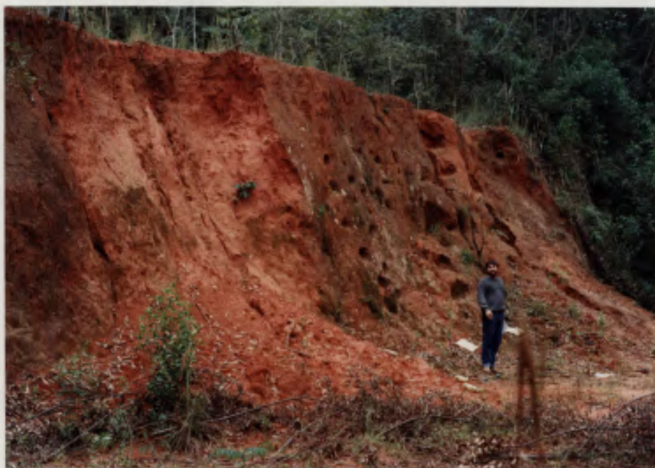
BARRANCO COM EVIDÊNCIAS DE DESMORONAMENTO.
