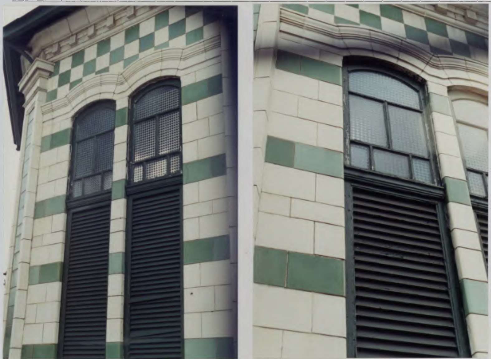
DETALHES DA ESTAÇÃO ELEVATORIA DISTINTAL DA AV. CONS. NEBRAS ESQ. COM AV. CAMPOS SALLES.
