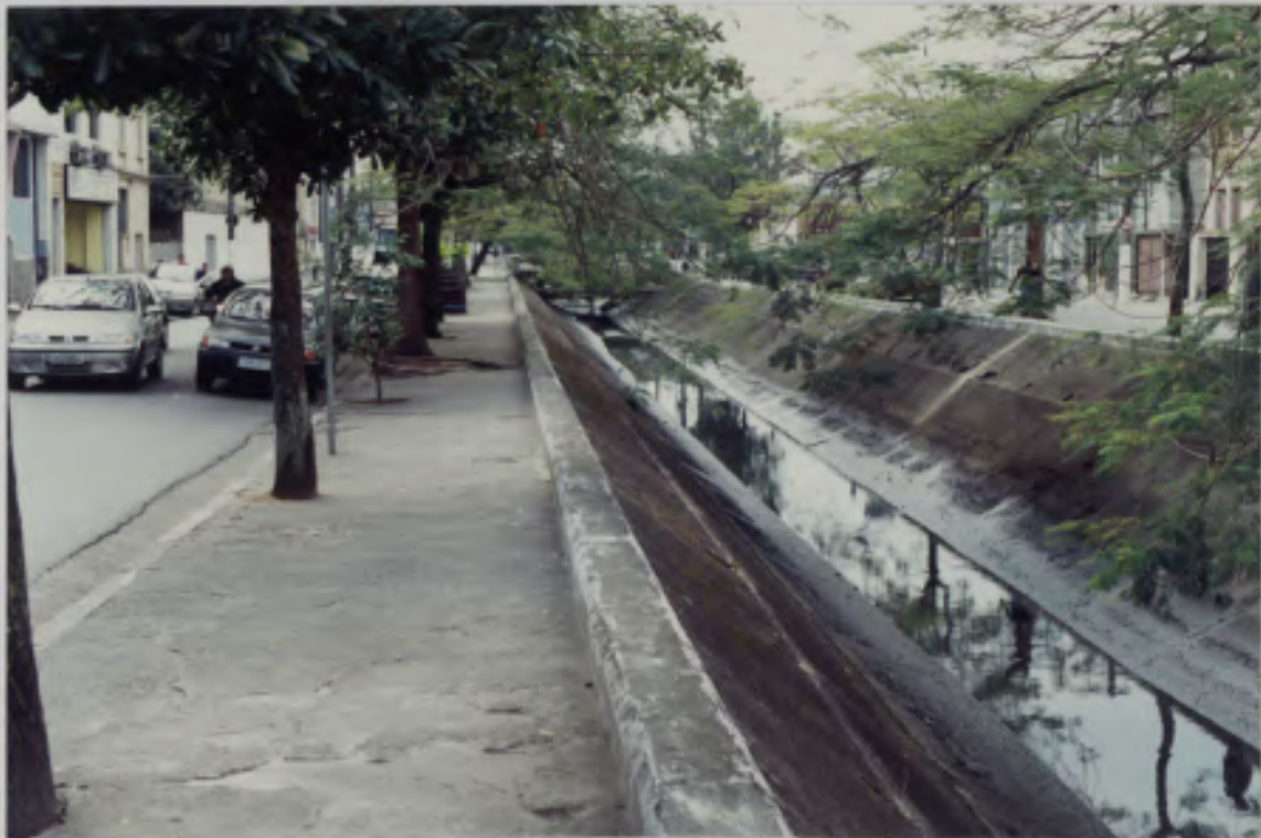
VISTA DA CONS. NÉBIAS P/ A AV. CAMPOS SALLES, EM PERSÃO À BACIA DO MERCADO. LAUSA 2003
