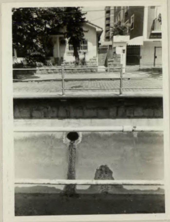
Condutor de águas pluviais por onde verte esgotos clandestinos e dreno vertendo água subterrânea
