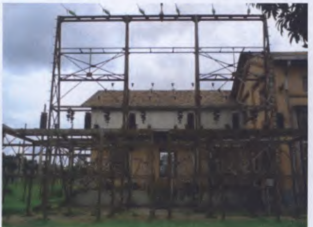
Subestação Elétrica (Art. 1º, V)
