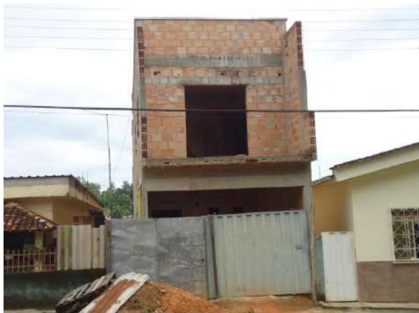
Pará de Minas Núcleo Histórico Urbano do Distrito de Ascensão Calçada em terra batida e obstáculos à circulação na Rua Abdon Senem de Araújo, obra não autorizada. (Foto 21)
