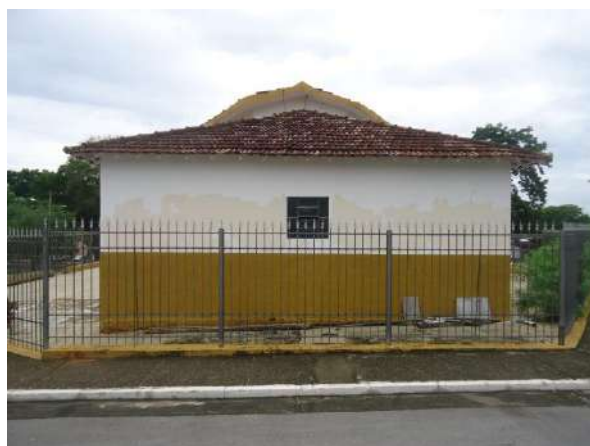
Pará de Minas Núcleo Histórico Urbano do Distrito de Ascensão Vista da fachada posterior da Igreja de Santo Antônio, com descolamento da pintura. (foto 42)
