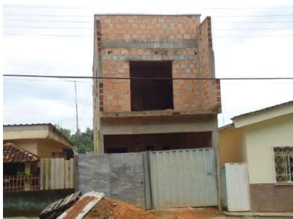
Pará de Minas Núcleo Histórico Urbano do Distrito de Ascensão Materiais de construção sobre o passeio na Avenida Abdon Senem de Araújo. (Foto 32)
