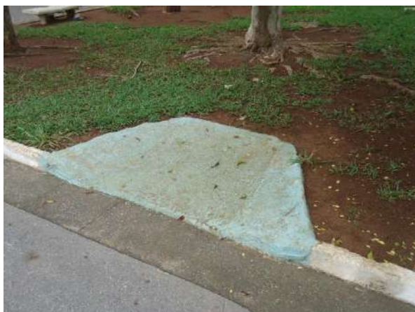
Pará de Minas Núcleo Histórico Urbano do Distrito de Ascensão Detalhe da rampa da Praça Santo Antônio que leva ao piso em terra batida e que não oferece acessibilidade. (Foto 25)
