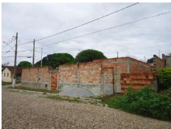
Pará de Minas Núcleo Histórico Urbano do Distrito de Ascensão Edificação à Avenida Presidente Kubitschek, 126. demolida sem autorização do Conselho. (foto 67)
