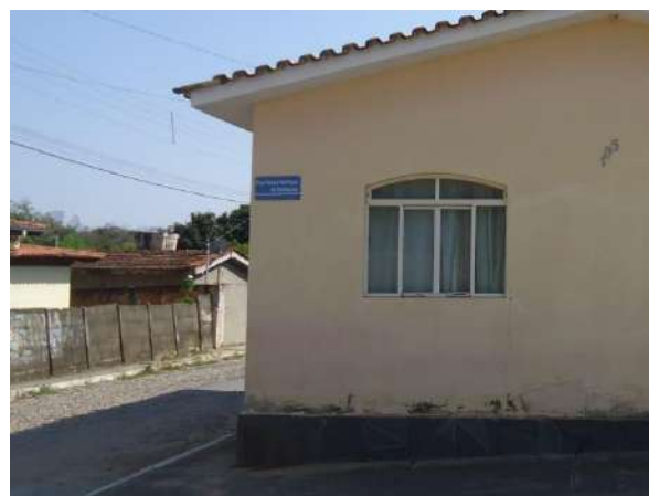
Pará de Minas Núcleo Histórico Urbano do Distrito de Carioca Placas de logradouro com camada pictórica desgastada na Rua Nossa Senhora Aparecida. (foto 09)
