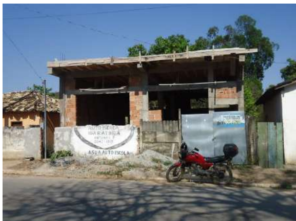
Núcleo Histórico Urbano do Distrito de Carioca Edificação comercial em fase de construção desde 2017 na via Praça Nossa Senhora de Lourdes. A obra não foi solicitada nem aprovada pelo Conselho Deliberativo Municipal do Patrimônio Cultural de Pará de Minas. (foto 107)
