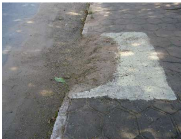
Pará de Minas Núcleo Histórico Urbano do Distrito de Carioca Sarjetas rasas e via da Praça Nossa Senhora de Lourdes apresentando grande acúmulo de areia. (foto 12)
