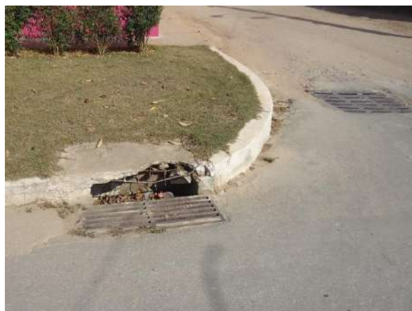
Pará de Minas Núcleo Histórico Urbano do Distrito de Carioca Detalhe da drenagem pluvial parcialmente obstruída na Rua São Francisco esquina com Rua Dom Bosco. (foto 11)
