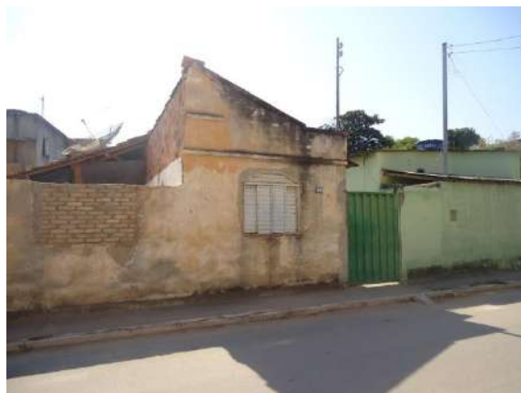
Núcleo Histórico Urbano do Distrito de Carioca Imóvel de número 100 da Rua Dona Maria Lopes Cançado parcialmente demolido, inclusive sua fachada frontal. A intervenção não foi solicitada nem aprovada pelo Conselho Deliberativo Municipal do Patrimônio Cultural de Pará de Minas. (foto 108)
