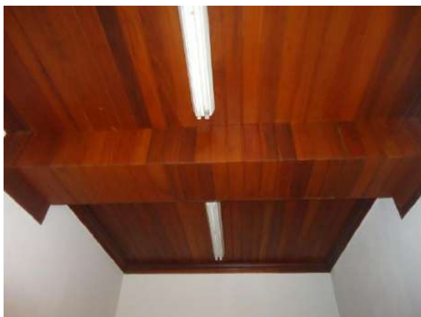
Pará de Minas Prédio Juscelino Kubitschek de Oliveira – Casa da Cultura Forro de uma das galerias do térreo do bem apresenta bom estado de conservação. (Foto 52)
