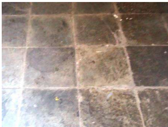
Pará de Minas Prédio Juscelino Kubitschek de Oliveira – Casa da Cultura A ardósia do porão apresenta desgastes em sua superfície, além de riscos e pequena perda de material em suas quinas. (Foto 49)
