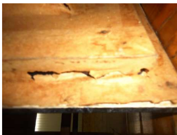
Pará de Minas Telas da Antiga Matriz de Nossa Senhora da Piedade Chassi sob ataque de insetos xilófagos, Especialmente em suas porções inferiores. (foto 34)
