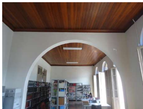
Pará de Minas Prédio Juscelino Kubitschek de Oliveira – Casa da Cultura Detalhe dos arcos estruturais de galeria no 1º pavimento da Casa da Cultura. (Foto 05) Imagem: Álisson Margotti – 16/10/2018
