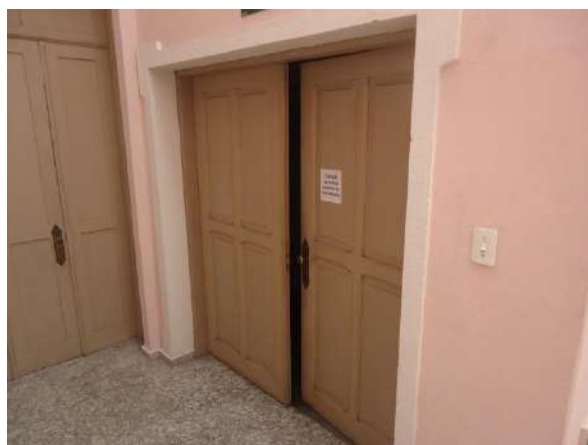
Pará de Minas Prédio Juscelino Kubitschek de Oliveira – Casa da Cultura Porta em estilo francês, em madeira e duas folhas, com chapas adornadas, exibem algum ressecamento. Não possui bandeiras e seus elementos artísticos se encontram em bom estado de conservação. Permite passagem do corredor à copa no térreo.
