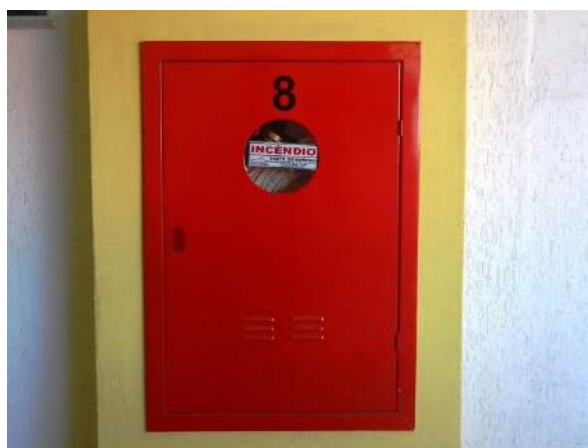
Pará de Minas Telas da Antiga Matriz NSP Instalações de combate à incêndio no prédio. (foto 57)
