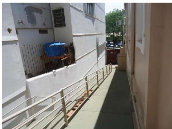
Pará de Minas Prédio Juscelino Kubitschek de Oliveira – Casa da Cultura Muro e área externa na lateral esquerda do bem exibe bom estado de conservação. (Foto 58) Imagem: Álisson Margotti – 16/10/2018
