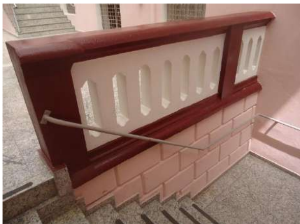
Pará de Minas Prédio Juscelino Kubitschek de Oliveira – Casa da Cultura Balaustre entre o átrio e as escadas estão em bom estado de conservação. Há um desnível de 1,85 m entre o nível do térreo e o nível do átrio.
