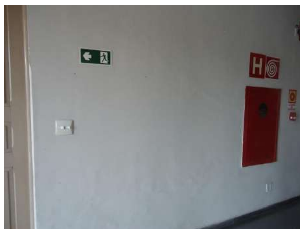
Pará de Minas Prédio Juscelino Kubitschek de Oliveira – Casa da Cultura Remendos superficiais e sujidades encontradas na alvenaria das áreas internas da edificação.
