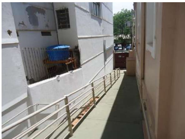
Pará de Minas Prédio Juscelino Kubitschek de Oliveira – Casa da Cultura Lateral direita do bem em piso cimentado que recebeu camada pictórica bem conservado. (Foto 45) Imagem: Álisson Margotti – 16/10/2018
