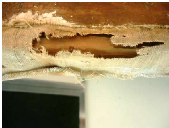
Pará de Minas Telas da Antiga Matriz de Nossa Senhora da Piedade Descolamento da tela no chassi e perda de material. (foto 22)
