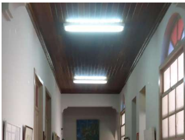
Pará de Minas Prédio Juscelino Kubitschek de Oliveira – Casa da Cultura Detalhe do forro no hall em bom estado de conservação. (Foto 50)
