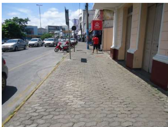
Pará de Minas Prédio Juscelino Kubitschek de Oliveira – Casa da Cultura O passeio defronte à edificação apresenta leves deslocamentos das peças intertravadas, além de algum acúmulo de sujidades. (Foto 62)
