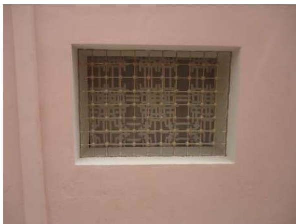
Pará de Minas Prédio Juscelino Kubitschek de Oliveira – Casa da Cultura Gradeamento das janelas do porão com estrutura e pintura bem conservadas. (Foto 33) Imagem: Álisson Margotti – 16/10/2018
