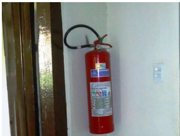
Pará de Minas Telas da Antiga Matriz NSP Instalações de combate a incêndio no interior do MUSPAM. (foto 53)
