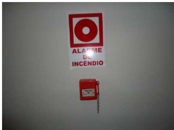
Pará de Minas Prédio Juscelino Kubitschek de Oliveira – Casa da Cultura Sistema de prevenção e combate a incêndio aprovado pelo Corpo de Bombeiros do município. (Foto 65) Imagem: Álisson Margotti – 16/10/2018
