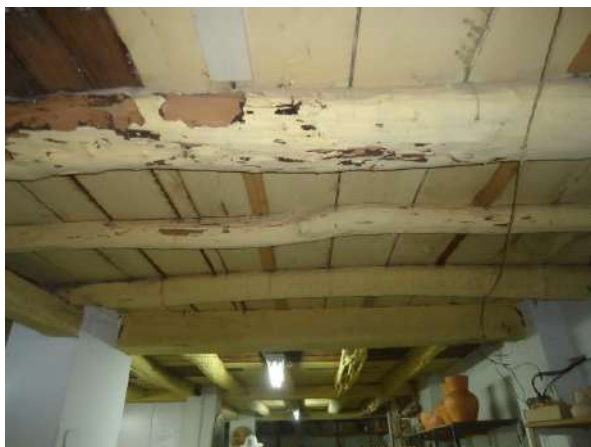
Pará de Minas E M de Artes e Ofícios SICA Vigas em madeira apresentam ataques de insetos xilófagos. (foto 05)
