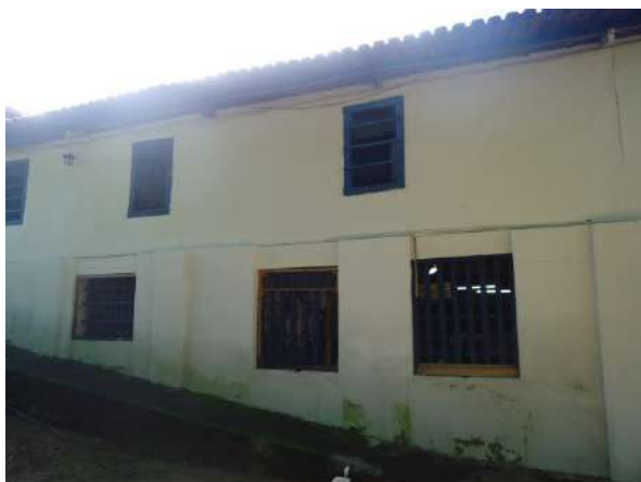
Pará de Minas E M de Artes e Ofícios SICA Reboco e pintura da fachada posterior não recebeu intervenção, exibindo machas e descolamentos. (foto 18) Imagem: Álisson Margotti – 26/11/2018
