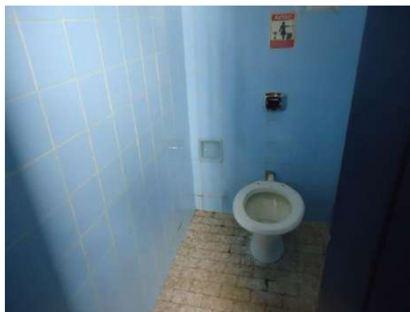
Pará de Minas E M de Artes e Ofícios SICA Instalações sanitárias do projeto hidráulico em bom estado de conservação. (foto 49) Imagem: Álisson Margotti – 26/11/2018
