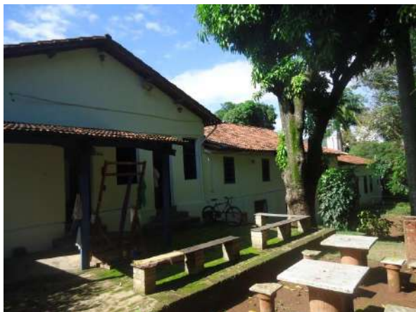
Pará de Minas E M de Artes e Ofícios SICA Varanda externa, sua estrutura é íntegra mas piso e cobertura apresentam manchas. (foto 39) Imagem: Álisson Margotti – 26/11/2018
