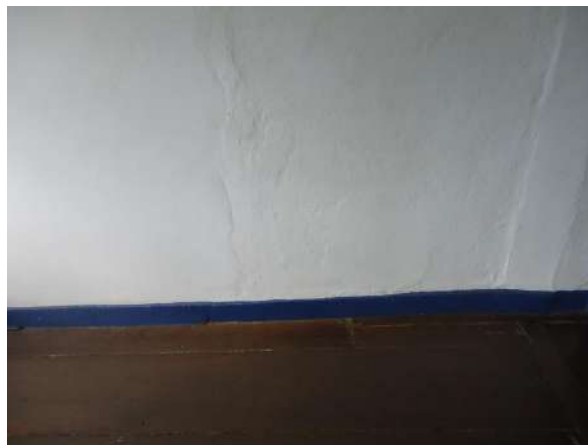
Pará de Minas E M de Artes e Ofícios SICA Alvenaria externa da fachada frontal também apresenta trincas. (foto 08)
