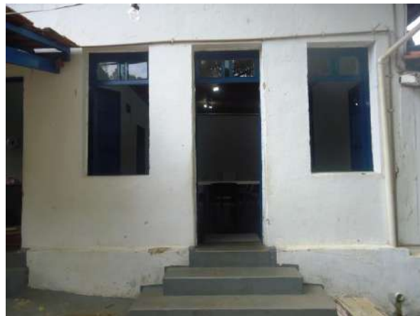
Pará de Minas E M de Artes e Ofícios SICA Janelas em madeira e vidro na fachada posterior da edificação exibe ressecamento da madeira e desgaste da camada pictórica, o enquadramento em massa apresenta pequena perda de material. (foto 27)
