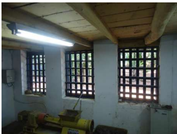
Pará de Minas E M de Artes e Ofícios SICA Janelas do porão na fachada posterior da edificação com esquadrias simples e gradeamento em madeira, ressecadas e pintura desgastada, o enquadramento em massa exibe trincas e perda de material. (foto 28)
