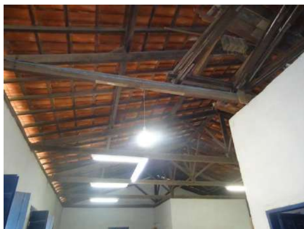
Pará de Minas E M de Artes e Ofícios SICA Madeiramento do telhado apresenta bom estado de conservação. (foto 10)
