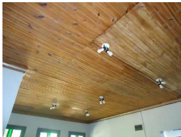
Pará de Minas E M de Artes e Ofícios SICA Forro em madeira do hall dos banheiros se encontra bem conservado. (foto 38)
