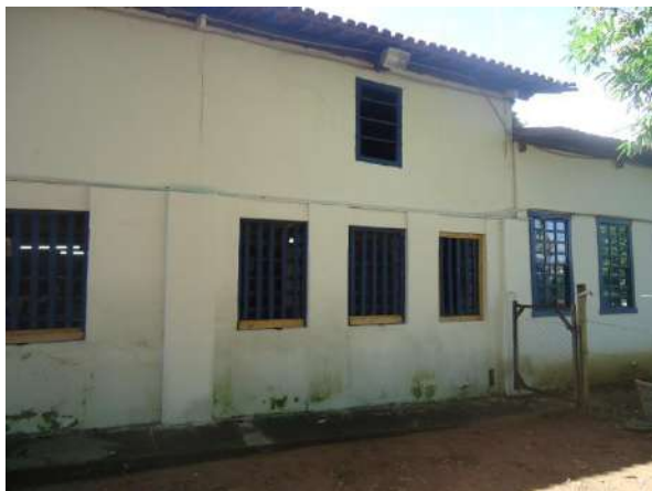
Pará de Minas E M de Artes e Ofícios SICA Alvenaria externa apresentando trincas, umidade e abaulamento . (foto 07)
