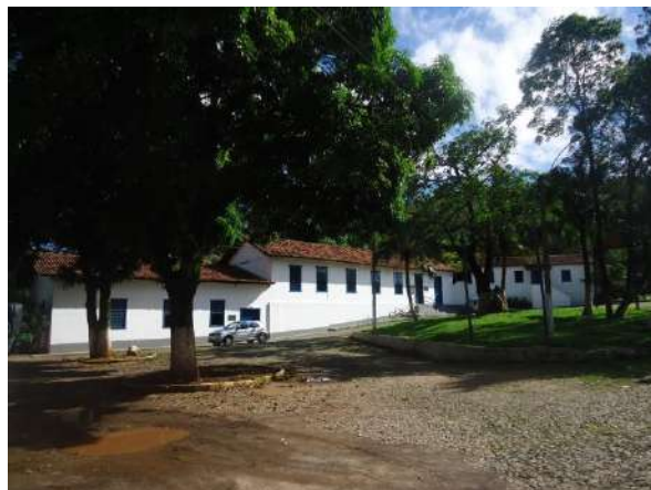
Pará de Minas E M de Artes e Ofícios SICA Conformação dos jardins no largo em frente ao bem apresenta ondulações e perda de material. (foto 42) Imagem: Álisson Margotti – 26/11/2018
