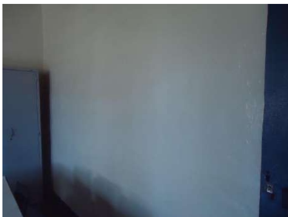
Pará de Minas E M de Artes e Ofícios SICA Reboco e pintura à óleo em parede interna exibindo bom estado de conservação. (foto 16) Imagem: Álisson Margotti – 26/11/2018
