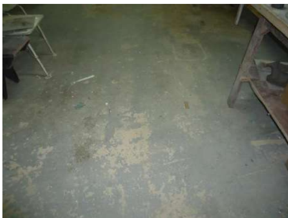
Pará de Minas E M de Artes e Ofícios SICA Piso cimentado do porão exibe desgaste em toda sua superfície. (foto 30)
