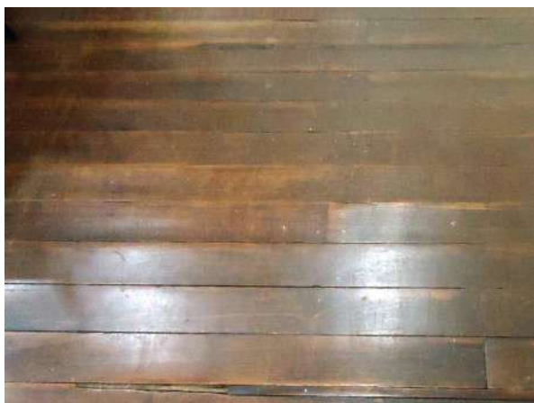
Pará de Minas E M de Artes e Ofícios SICA Assoalho da sala de exposição do térreo Apresenta desgaste remendos mal executados. (foto 32) Imagem: Álisson Margotti – 26/11/2018
