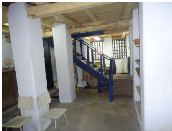
Pará de Minas E M de Artes e Ofícios SICA Vigas e pilares suportando o assolho exibem perda de material ocasionada pelo ataque de insetos. (foto 06)
