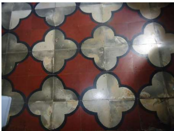
Pará de Minas E M de Artes e Ofícios SICA Ladrilho do hall dos banheiros exibe desgaste e manchas escuras. (foto 34) Imagem: Álisson Margotti – 26/11/2018
