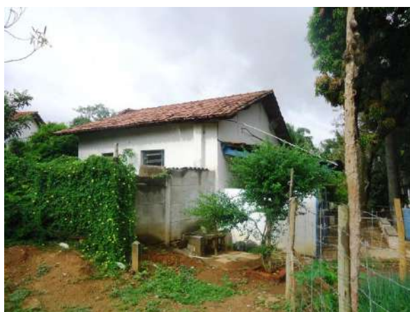
Pará de Minas Escola Municipal de Artes e Ofícios Raimundo Nogueira de Faria – SICA Fachada lateral esquerda (foto 04)
