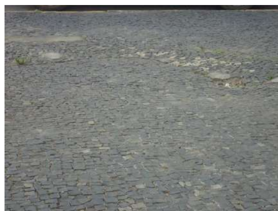
Pará de Minas Praças Torquato de Almeida e Francisco Torquato Remendo do piso com concreto. (Foto 18)
