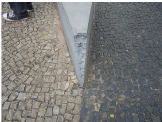
Pará de Minas Praças Torquato de Almeida e Francisco Torquato Detalhe dos bancos em concreto com perda de material em sua extremidade. (Foto 46)
