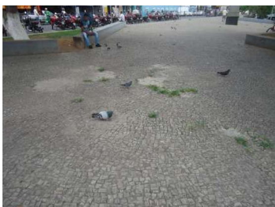
Pará de Minas Praças Torquato de Almeida e Francisco Torquato Peças mal instaladas e concreto em trecho do piso. (Foto 19)
