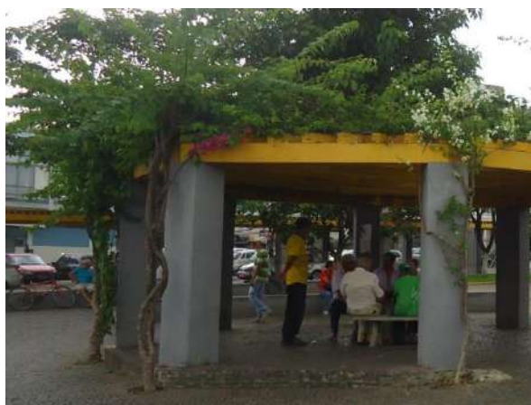
Pará de Minas Praças Torquato de Almeida e Francisco Torquato Detalhe do caramanchão das praças em bom estado de conservação.
