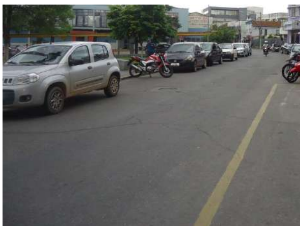
Pará de Minas Praças Torquato de Almeida e Francisco Torquato Revestimento asfáltico bem conservado. (Foto 06)
