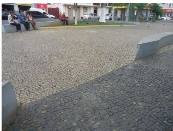
Pará de Minas Praças Torquato de Almeida e Francisco Torquato Acúmulo de sujidades entre as peças e perda de algumas. (Foto 17)
