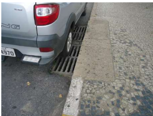
Pará de Minas Praças Torquato de Almeida e Francisco Torquato Boca de lobo em concreto exibindo trincas e perda de material. (Foto 11)
