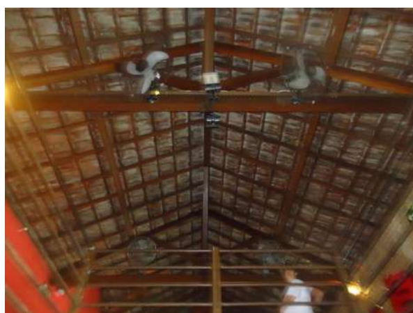
Pará de Minas Antiga Estação Ferroviária Madeiramento do telhado em bom estado. (foto 06)
