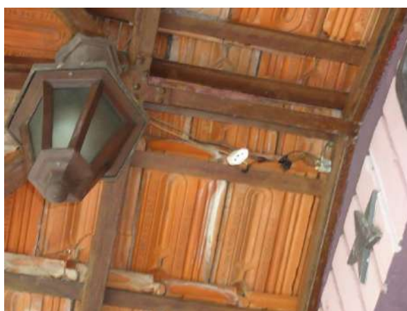
Pará de Minas Antiga Estação Ferroviária Exemplo de uma das fiações aparentes e expostas, com remendos mal executados colocando em risco à edificação histórica. (foto 50)
