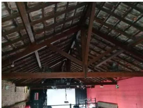
Pará de Minas Antiga Estação Ferroviária Na maior parte da edificação o madeiramento bem conservado do telhado é aparente. (foto 43) Imagem: Álisson Margotti – 29/10/2018
