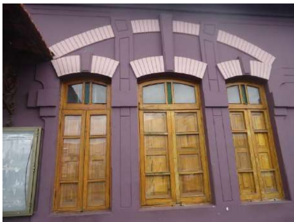
Pará de Minas Antiga Estação Ferroviária Janelas da fachada frontal da Estação em madeira e vidro, enquadramento em massa sobreverga e elementos artísticos em bom estado, alguns pontos da pintura exibem desgaste e perda. (foto 27)
