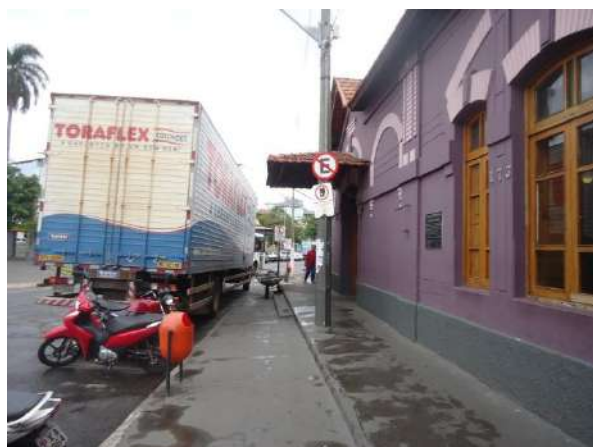
Pará de Minas Antiga Estação Ferroviária Passeio na fachada frontal do bem exibindo sujidades em sua superfície. (foto 48)
