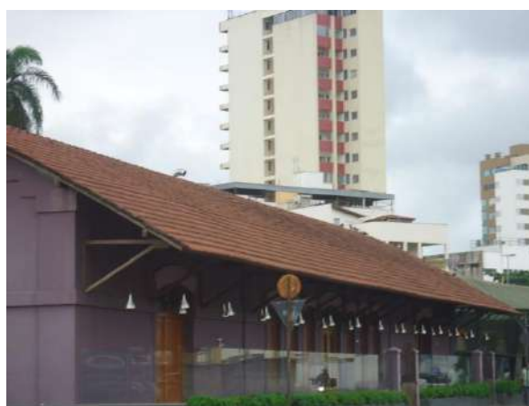
Pará de Minas Antiga Estação Ferroviária Telhas francesas exibem algumas manchas. (foto 07)
