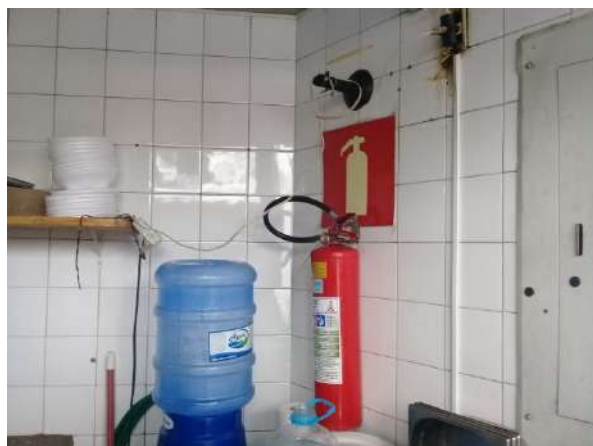
Pará de Minas Antiga Estação Ferroviária Extintor de incêndio na área de shows. (foto 50) Imagem: Álisson Margotti – 29/10/2018
