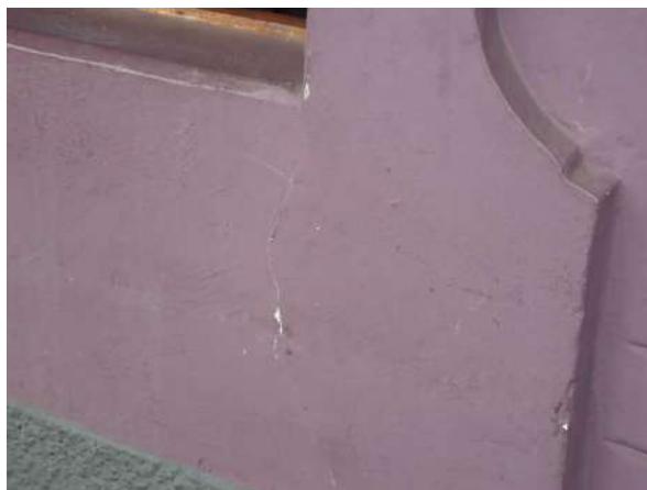
Pará de Minas Antiga Estação Ferroviária A estrutura em tijolo autoportante apresentando trincas Na fachada posterior do bem. (foto 05)
