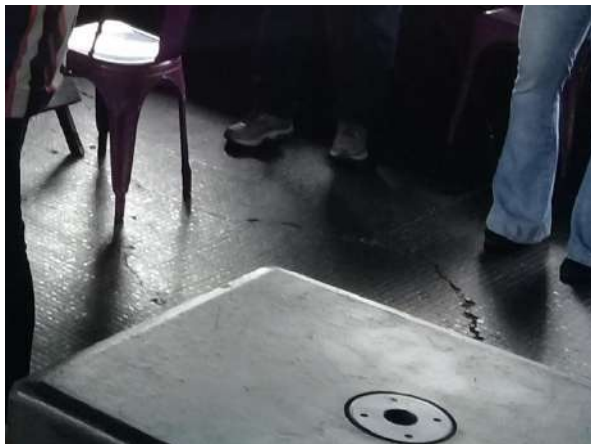
Pará de Minas Antiga Estação Ferroviária Ladrilhos do térreo exibindo remendos e perda de peças. (foto 35)
