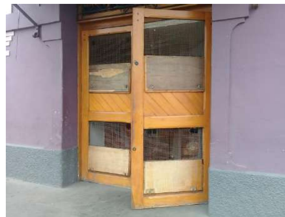
Pará de Minas Antiga Estação Ferroviária Vista externa de porta da fachada frontal apresenta péssima conservação da madeira e ferragens e seus elementos artísticos integrados, e folhas com remendos em telas. (foto 22)
