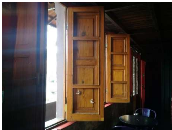
Pará de Minas Antiga Estação Ferroviária Vista interna das janelas da fachada frontal em madeira e vidro (vidro sob o piso do mezanino) e enquadramento em massa exibindo rachaduras, a camada pictórica está bem conservada. (foto 28)
