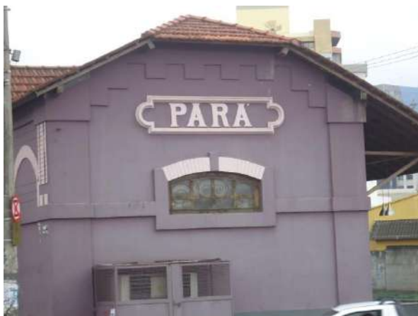
Pará de Minas Antiga Estação Ferroviária Janela da fachada lateral esquerda em ferro e vidro, enquadramento em massa sobreverga e elementos artísticos em bom estado, alguns pontos da pintura exibem desgaste. (foto 29)
