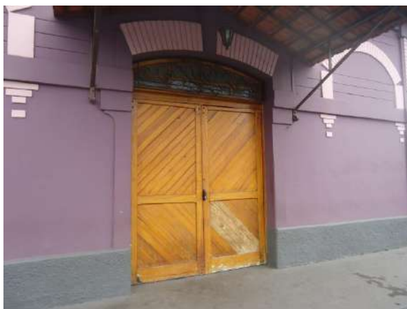
Pará de Minas Antiga Estação Ferroviária Porta lateral na fachada frontal do bem exibe regular estado de conservação da madeira, e ferragens e de seus elementos artísticos apenas o enquadramento em massa exibe desgaste. (foto 21)
