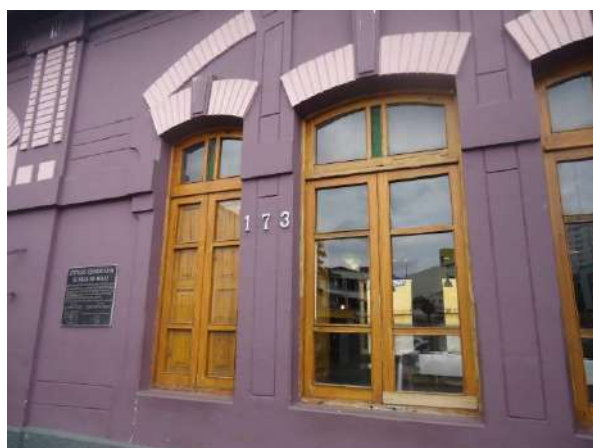
Pará de Minas Antiga Estação Ferroviária Reboco e pintura externos exibem algum desgaste. (foto 12)
