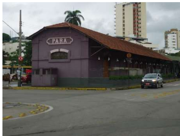
Pará de Minas Antiga Estação Ferroviária Passeio na fachada posterior da edificação também apresenta sujidades. (foto 49)
