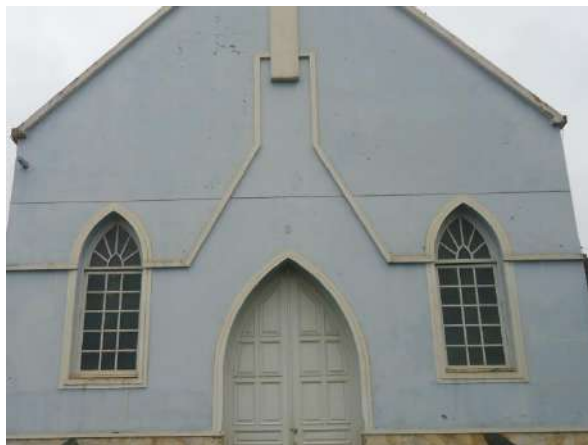
Pará de Minas Asilo Padre José Pereira Coelho Reboco e camada pictórica externa da Capela exhibe desgaste e perda de material.
