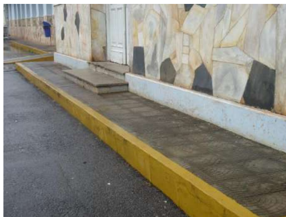
Pará de Minas Asilo Padre José Pereira Coelho Piso em concreto no passeio da fachada frontal apresenta algumas manchas de umidade. (foto 44)
