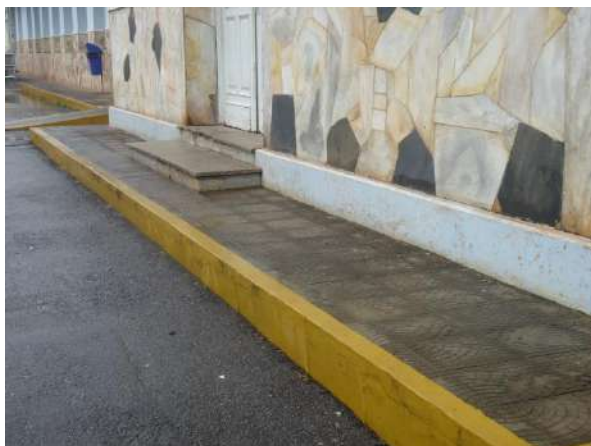
Pará de Minas Asilo Padre José Pereira Coelho Pedras ouro preto no barrado externo do bem exibem bom estado de conservação. (foto 19)
