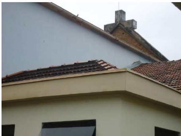
Pará de Minas Asilo Padre José Pereira Coelho Telhas francesas exibem manchas de umidade. (foto 06) Imagem: Álisson Margotti – 25/10/2018
