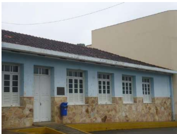
Pará de Minas Asilo Padre José Pereira Coelho Fachada lateral esquerda recebeu anexo. (foto 02) Imagem: Álisson Margotti – 25/10/2018
