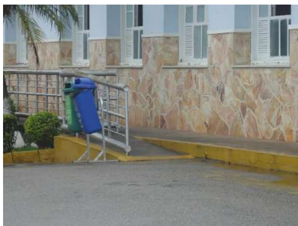
Pará de Minas Asilo Padre José Pereira Coelho Rampa de acesso à entrada secundária da faculdade exibe boa conservação. (foto 54)
