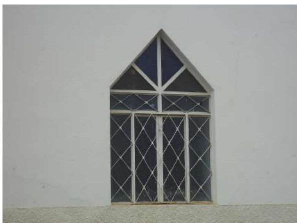
Pará de Minas Asilo Padre José Pereira Coelho Vista externa da janela do altar em metal e vidro apresenta bom estado de conservação. (foto 29)
