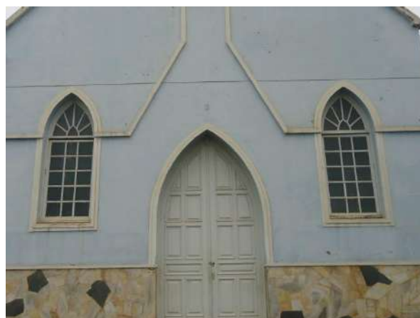
Pará de Minas Asilo Padre José Pereira Coelho Janelas da fachada frontal em metal e vidro e enquadramento em massa bem conservadas, peitoris e sobrevergas ogivais necessitam de novas pinturas. (foto 30)
