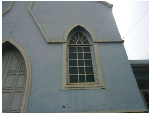
Pará de Minas Asilo Padre José Pereira Coelho Alvenarias externas à direita da capela apresentam boa conservação. (foto 10) Imagem: Álisson Margotti – 25/10/2018
