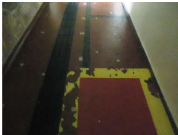
Pará de Minas Asilo Padre José Pereira Coelho Cerâmica em mosaicos no piso dos corredores exibem bom estado, mas leve desgaste. (foto 42)
