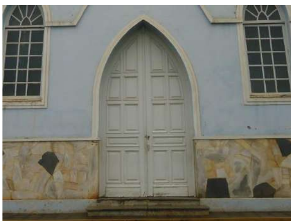
Pará de Minas Asilo Padre José Pereira Coelho Porta em madeira de acesso à Capela, enquadramento em massa e pintura bem conservados. (foto 21)
