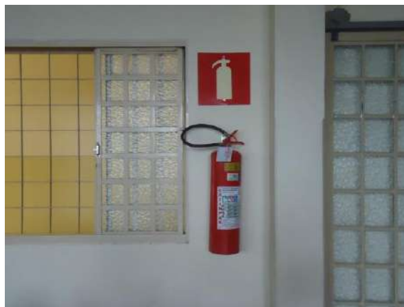
Pará de Minas Asilo Padre José Pereira Coelho Extintor afixado no auditório.. (foto 57) Imagem: Álisson Margotti – 25/10/2018
