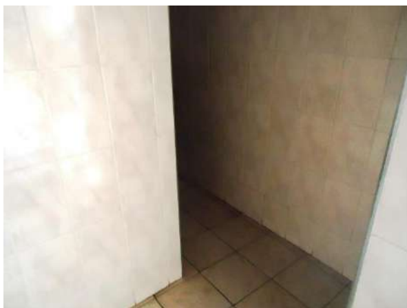
Pará de Minas Asilo Padre José Pereira Coelho Piso cerâmico dos banheiros em bom estado de conservação. (foto 39)
