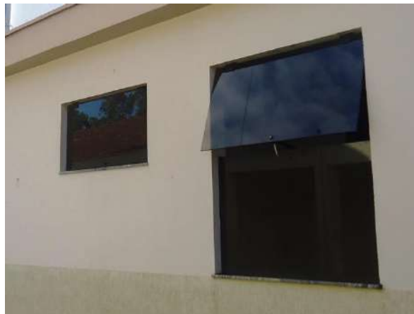
Pará de Minas Asilo Padre José Pereira Coelho Janelas dos fundos da recepção em metal e vidro e enquadramento em massa bem conservadas. (foto 32) Imagem: Álisson Margotti – 25/10/2018
