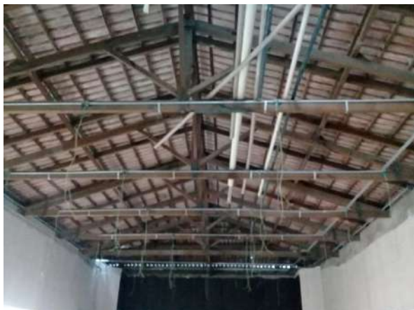
Pará de Minas Centro Literário Pedro Nestor Manto da cobertura e madeiramento em bom estado, exhibe apenas manchas de umidade. (foto 05) Imagem: Álisson Margotti – 05/10/2018
