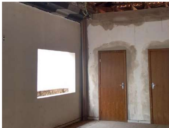
Pará de Minas Centro Literário Pedro Nestor Vista interna de condutores de águas pluviais em bom estado de conservação. (foto 06) Imagem: Álisson Margotti – 05/10/2018
