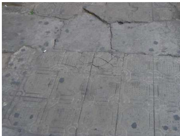
Pará de Minas Centro Literário Pedro Nestor Desgaste dos ladrilhos em cimento do passeio ocasionado pelo materiais de construção aí acondicionados. (foto 36)
