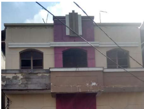
Pará de Minas Centro Literário Pedro Nestor Sacada da fachada frontal do Centro já restaurada, necessita de finalização da pintura. (foto 32)
