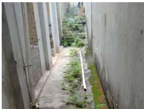
Pará de Minas Centro Literário Pedro Nestor Quintal e muro laterais direitos também apresentam sujidades e escombros. (foto 35)
