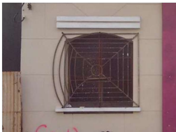
Pará de Minas Centro Literário Pedro Nestor Janela em madeira e vidro que será restaurada, enquadramento, peitoril e sobreverga em bom estado. (foto 20)
