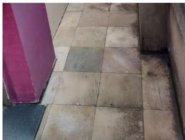
Pará de Minas Centro Literário Pedro Nestor Piso novo com sujidades na sacada da fachada frontal. (foto 29)
