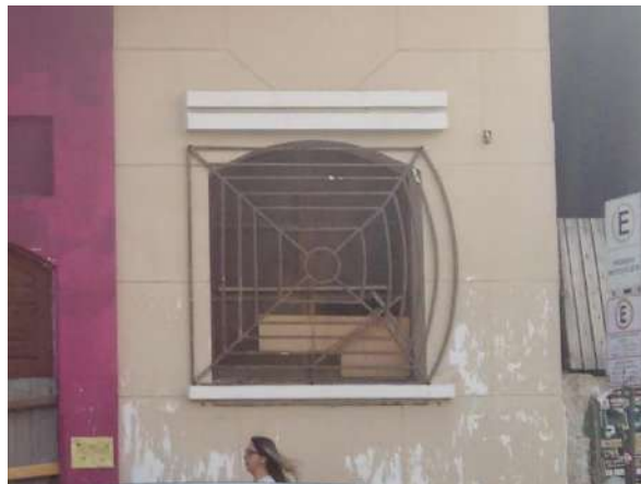
Pará de Minas Centro Literário Pedro Nestor Janela em madeira e vidro que será restaurada, enquadramento, peitoril e sobreverga em bom estado. (foto 19)
