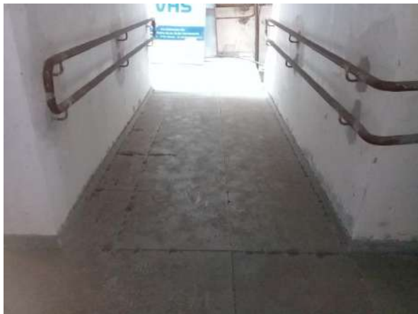
Pará de Minas Centro Literário Pedro Nestor Piso novo com acúmulo de pó hall de entrada e escada no térreo. (foto 26)
