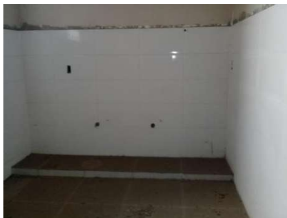
Pará de Minas Centro Literário Pedro Nestor Cerâmicas sendo instaladas no ambiente que abrigará a copa. (foto 13) Imagem: Álisson Margotti – 05/10/2018
