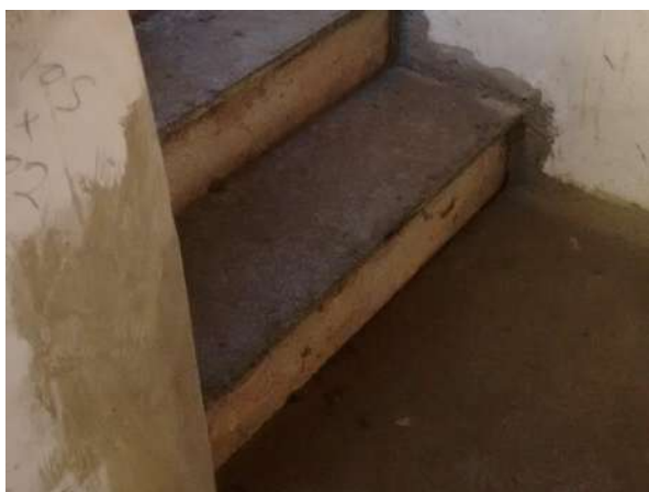
Pará de Minas Centro Literário Pedro Nestor Granito novo com acúmulo de pó nas escadarias da edificação. (foto 28)
