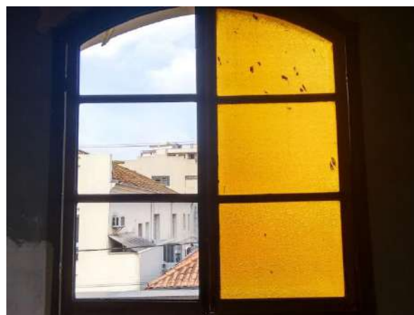
Pará de Minas Centro Literário Pedro Nestor Vista interna da janela em madeira e vidro em estado precário no térreo, a janela ainda será restaurada. (foto 21)
