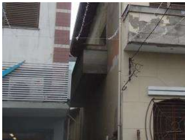
Pará de Minas Centro Literário Pedro Nestor Sacada da fachada lateral direita necessita de camada pictórica. (foto 33)
