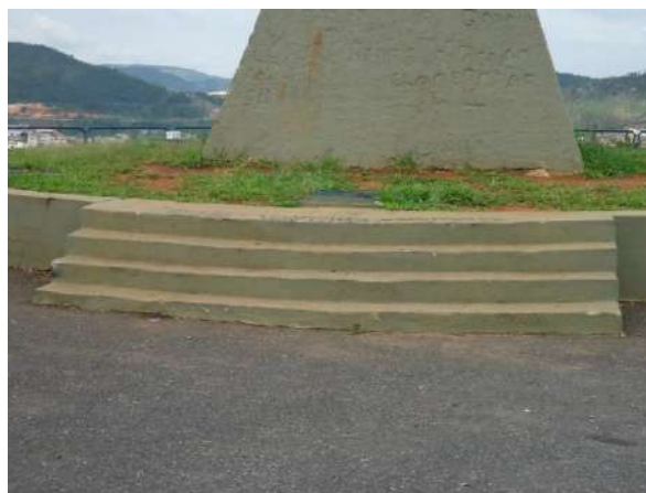
Pará de Minas Cristo Redentor A escada não apresenta danos na sua estrutura, mas exibe vandalismo e desgaste da pintura. (foto 14)
