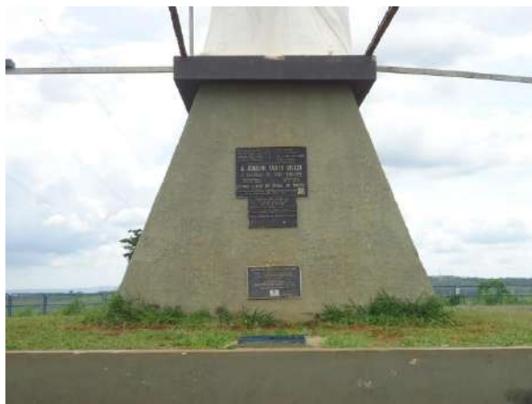
Pará de Minas Cristo Redentor O pedestal de tijolos exibe bom estado de conservação. (foto 06)
