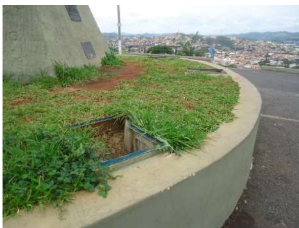
Pará de Minas Cristo Redentor Instalações elétricas sem funcionamento no bem tombado. (foto 21) Imagem: Álisson Margotti – 19/10/2018
