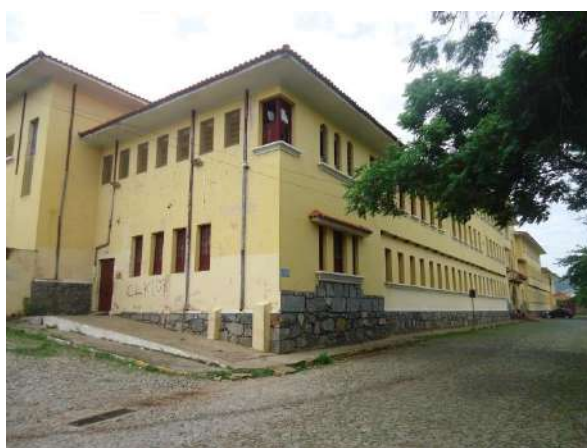
Pará de Minas Escola Estadual Fernando Otávio A estrutura em concreto armado do bem se encontra em bom estado de conservação. (foto 03) Imagem: Álisson Margotti – 19/10/2018
