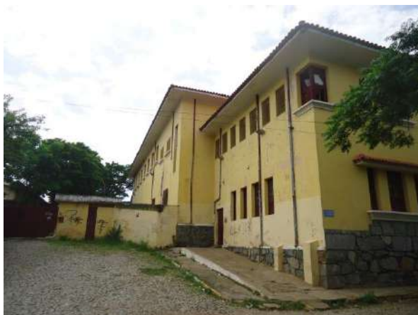
Pará de Minas Escola Estadual Fernando Otávio Condutores em aço galvanizado exibem amassados e oxidações. (foto 06) Imagem: Álisson Margotti – 19/10/2018
