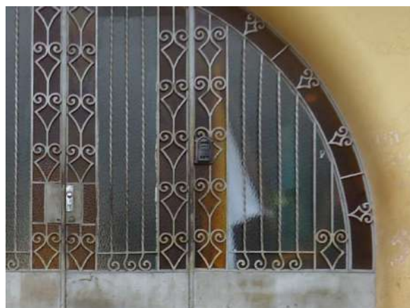
Pará de Minas Escola Estadual Fernando Otávio Interfone no portão principal que dá acesso à edificação. (foto 36)
