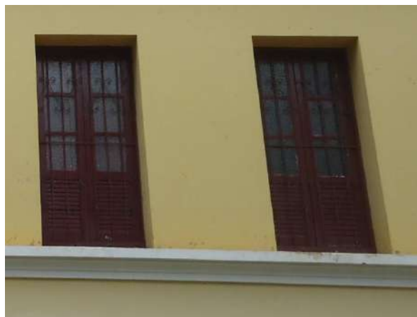
Pará de Minas Escola Estadual Fernando Otávio Janelas do pavimento térreo apresentam madeiras ressecadas, grades necessitando de pintura, os enquadramentos se encontram íntegros. (foto 16) Imagem: Álisson Margotti – 19/10/2018
