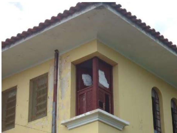
Pará de Minas Escola Estadual Fernando Otávio Janelas na quina do 2º pavimento entre a fachada frontal e lateral direita apresenta ressecamento da madeira, peitoril íntegro e acúmulo de massa em sua superfície. (foto 19)
