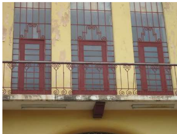
Pará de Minas Escola Estadual Fernando Otávio Laje da sacada apresenta manchas ocasionadas por umidade. (foto 29) Imagem: Álisson Margotti – 19/10/2018
