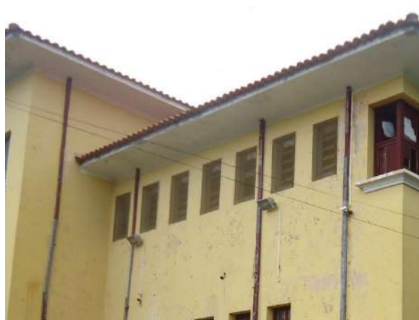
Pará de Minas Escola Estadual Fernando Otávio Janelas basculantes em metal e vidro e grade em tela e metal na fachada lateral direita da edificação, o enquadramento está bem conservado, mas todo o conjunto precisa de nova pintura. (foto 22)
