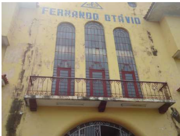
Pará de Minas Escola Estadual Fernando Otávio Sacada e seus elementos (laje, cachorros e guarda-corpo) se encontram íntegros mas com camada pictórica precária. (foto 30)
