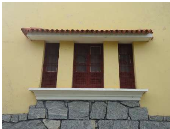
Pará de Minas Escola Estadual Fernando Otávio Janela do térreo na projeção da fachada apresenta ressecamento da madeira, vidros quebrados, enquadramento em massa, peitoril e sobreverga se apresentam íntegros. (foto 20)
