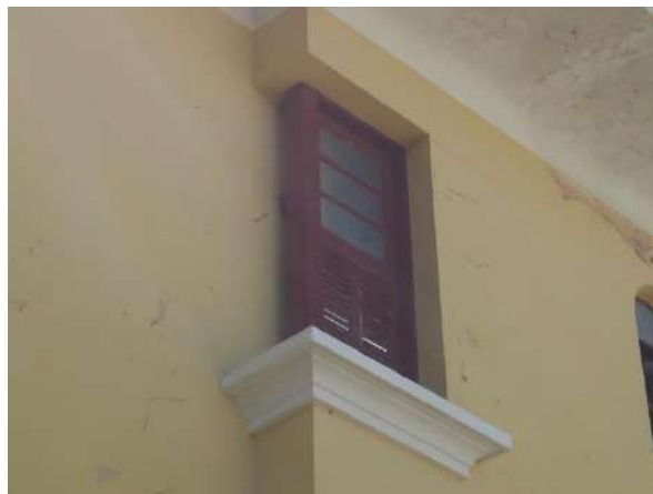
Pará de Minas Escola Estadual Fernando Otávio Janela em madeira do segundo pavimento na projeção da fachada frontal apresenta ressecamento e perda de material nas persianas fixas. (foto 18) Imagem: Álisson Margotti – 19/10/2018
