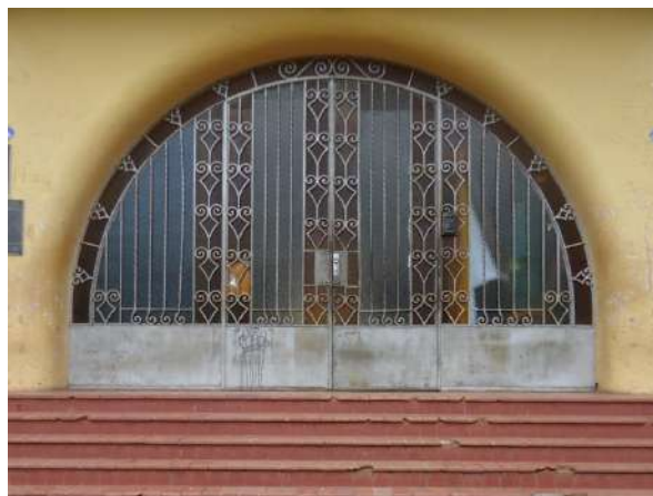
Pará de Minas Escola Estadual Fernando Otávio Portada simples com enquadramento curvo em bom estado de conservação. Escadaria apresenta revestimento cerâmico desgastado, com trincas perda de material e remendos em cimento. (foto 31)
