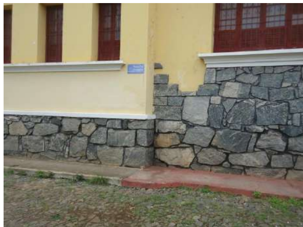
Pará de Minas Escola Estadual Fernando Otávio Cimento apresenta trincas, manchas e perda de material. (foto 33)
