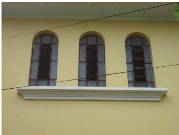
Pará de Minas Escola Estadual Fernando Otávio Janelas do térreo e 1º pavimento em projeção semelhante nas porções esquerda e direita da fachada frontal, as seteiras estão bem conservadas. (foto 17) Imagem: Álisson Margotti – 19/10/2018
