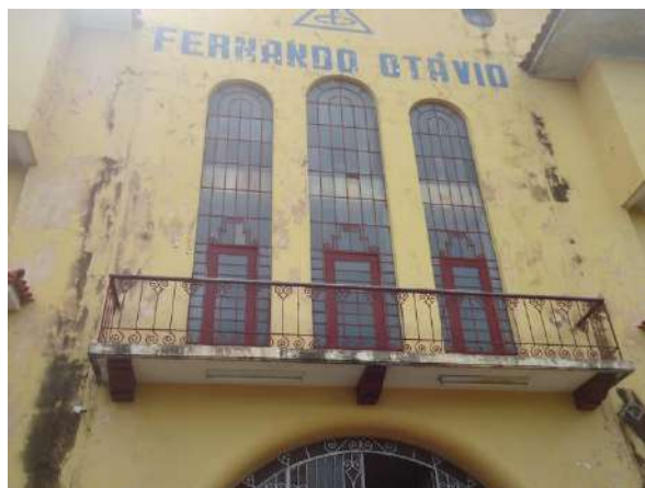
Pará de Minas Escola Estadual Fernando Otávio Reboco e pintura apresentando umidade, craquelês, e perdas de material em grandes áreas.. (foto 12) Imagem: Álisson Margotti – 19/10/2018
