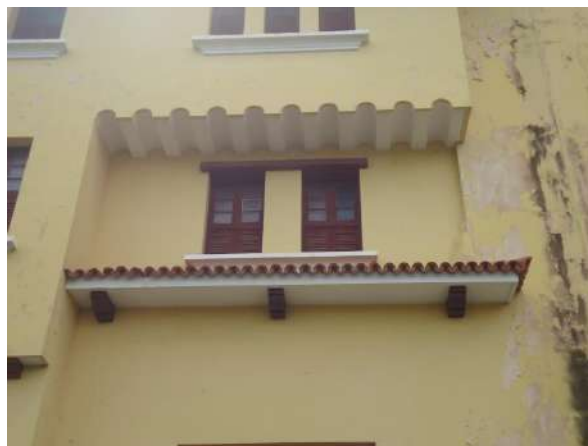
Pará de Minas Escola Estadual Fernando Otávio Elementos artísticos da alvenaria necessitam de renovação da camada pictórica. (foto 10) Imagem: Álisson Margotti – 19/10/2018
