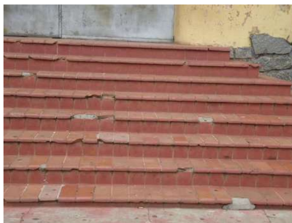
Pará de Minas Escola Estadual Fernando Otávio A cerâmica da escada apresenta trincas, remendos, manchas, perda de material e desgaste da superfície. (foto 27) Imagem: Álisson Margotti – 19/10/2018
