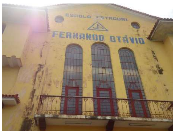
Pará de Minas Escola Estadual Fernando Otávio Telhas capa e bica das coberturas apresentam manchas de umidade. (foto 04) Imagem: Álisson Margotti – 19/10/2018
