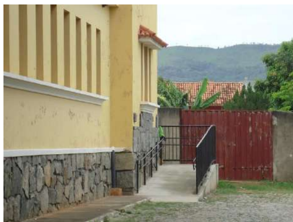
Pará de Minas Escola Estadual Fernando Otávio Cimento e cimento pintado apresentam trincas, manchas e perda de material. (foto 26) Imagem: Álisson Margotti – 19/10/2018
