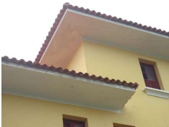
Pará de Minas Escola Estadual Fernando Otávio Laje dos beirais apresentam manchas de umidade e estufamentos. (foto 28) Imagem: Álisson Margotti – 19/10/2018
