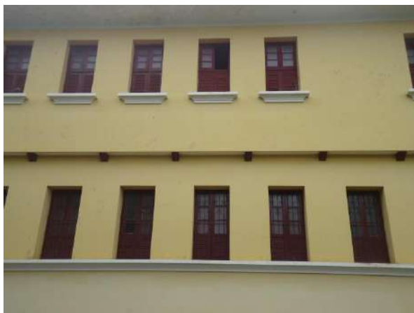
Pará de Minas Escola Estadual Fernando Otávio Janelas dos 1º e 2º pavimento apresentam ressecamento da madeira. os enquadramentos se encontram íntegros. (foto 15) Imagem: Álisson Margotti – 19/10/2018
