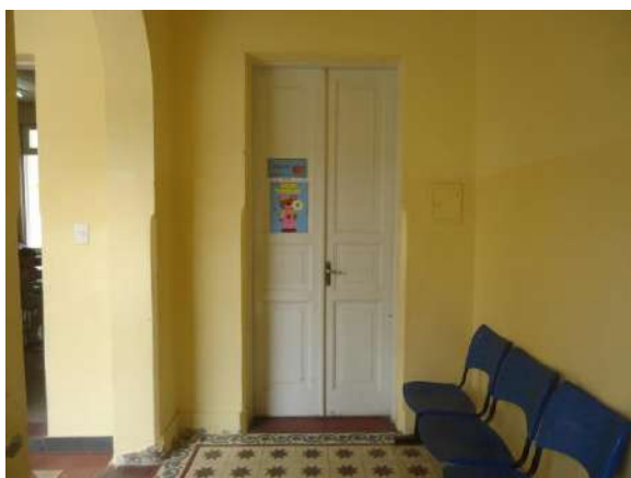
Pará de Minas Escola Estadual Governador Valadares Reboco e pinturas à óleo e à base de água comum às paredes do bem estão bem conservadas. (foto 15) Imagem: Álisson Margotti – 06/11/2018
