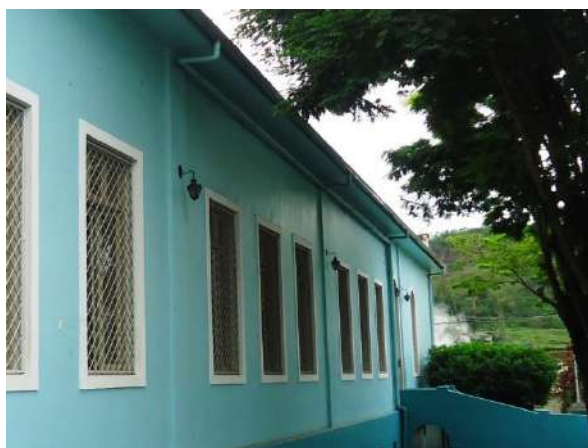
Pará de Minas Escola Estadual Torquato de Almeida Beiral e condutores de águas pluviais apresentam bom estado de conservação. (foto 10)
