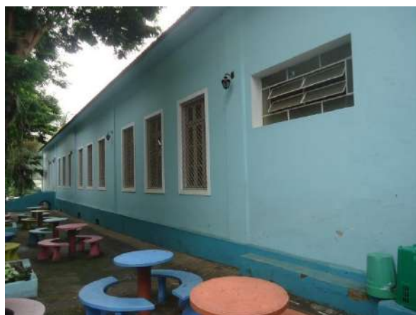
Pará de Minas Escola Estaduai Torquato de Almeida Reboco e pintura da lateral esquerda bem conservadas mas com algum acúmulo de sujidades. (foto 14) Imagem: Álisson Margotti – 06/11/2018
