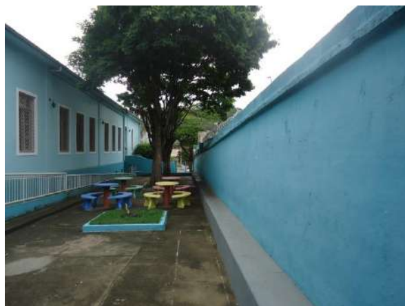
Par  de Minas Escola Estaduai Torquato de Almeida Quintal na lateral esquerda da edifica o seu piso apresenta trincas e manchas de umidade. (foto 41)
