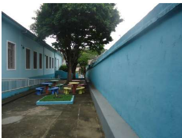
Pará de Minas Escola Estadual Torquato de Almeida Jardim lateral esquerdo, a conformação das áreas das árvores apresenta trincas e perda de material. (foto 36) Imagem: Álisson Margotti – 06/11/2018
