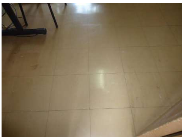
Pará de Minas Escola Estadual Torquato de Almeida Cerâmica das salas de secretaria exibem bom estado de conservação. (foto 31) Imagem: Álisson Margotti – 06/11/2018
