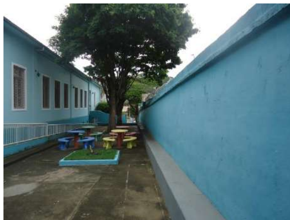
Pará de Minas Escola Estaduai Torquato de Almeida Cimentado no quintal da lateral esquerda exibe trincas e manchas de umidade. (foto 26)
