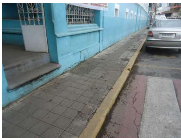
Pará de Minas Escola Estadual Torquato de Almeida Passeio do bem apresenta perda de material e remendos mal executados.
