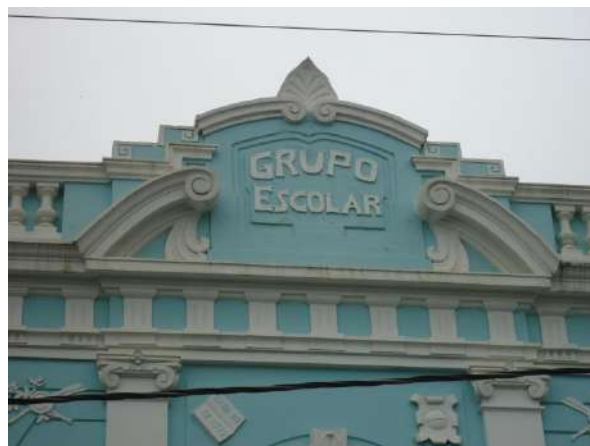
Pará de Minas Escola Estadual Torquato de Almeida Frontão ornamentado se apresentou bem conservado. (foto 09)
