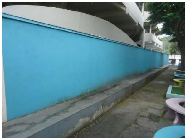
Par  de Minas Escola Estadual Torquato de Almeida Muro lateral esquerdo do bem apresenta bom estado de conserva o. (foto 38)
