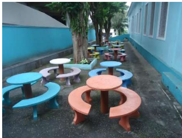
Pará de Minas Escola Estadual Torquato de Almeida Jardim lateral direito, a conformação das áreas das árvores apresenta trincas e perda de material. (foto 35) Imagem: Álisson Margotti – 06/11/2018
