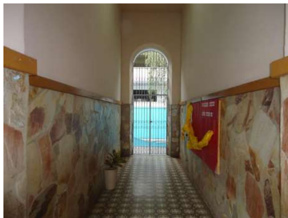
Pará de Minas Escola Estaduai Torquato de Almeida Pedras São Tomé revestindo todo o refeitório se apresentam bem conservadas. (foto 16)
