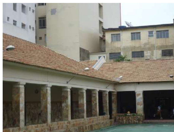
Pará de Minas Escola Estaduai Torquato de Almeida Telhas francesas bem conservadas. (foto 07)
