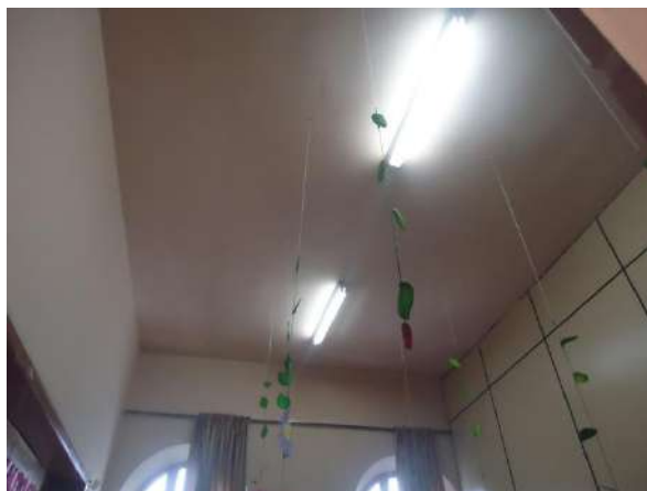
Pará de Minas Escola Estadual Torquato de Almeida A estrutura em concreto armado não apresenta danos aparentes. (foto 05)
