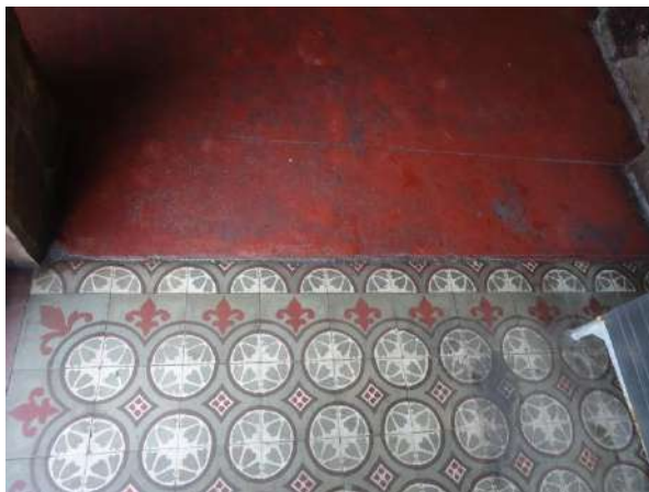
Pará de Minas Escola Estadual Torquato de Almeida Cimento vermelho do refeitório e palco em bom estado, exibe poucas trincas. (foto 27)
