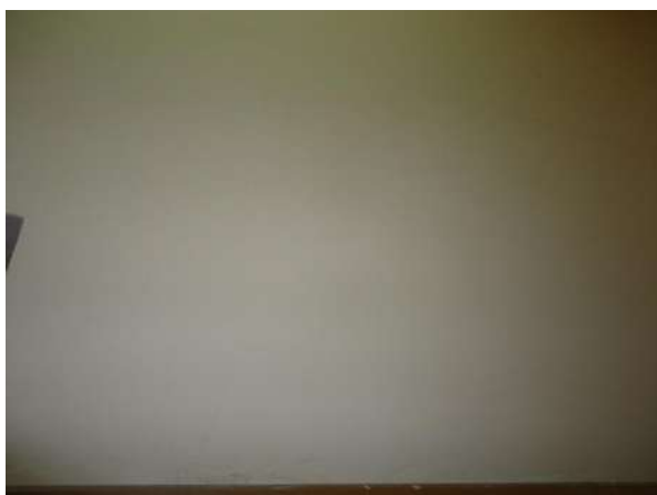
Pará de Minas Escola Estadual Torquato de Almeida Reboco e pintura de uma das salas de aula exibe bom estado de conservação. (foto 13) Imagem: Álisson Margotti – 06/11/2018
