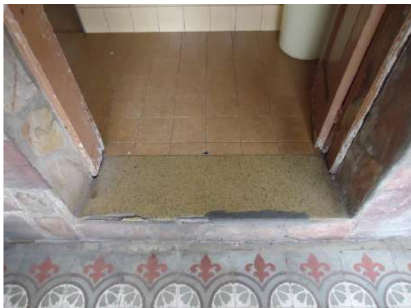
Pará de Minas Escola Estadual Torquato de Almeida Cerâmica comum aos banheiros da edificação exibe desgastes pelo uso constante. (foto 29) Imagem: Álisson Margotti – 06/11/2018
