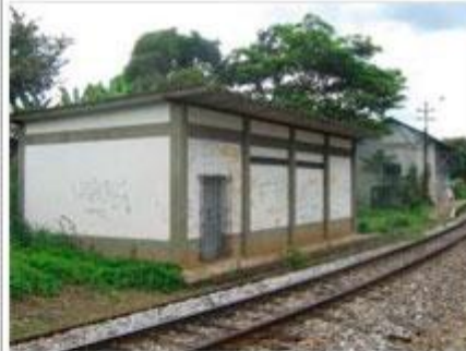
Foto 03 - Vista da subestação elétrica. Data: 17/03/10
