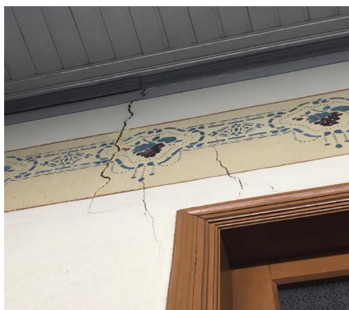
Imagem 2: Rachadura localizada na alvenaria estrutural interna do edifício.
