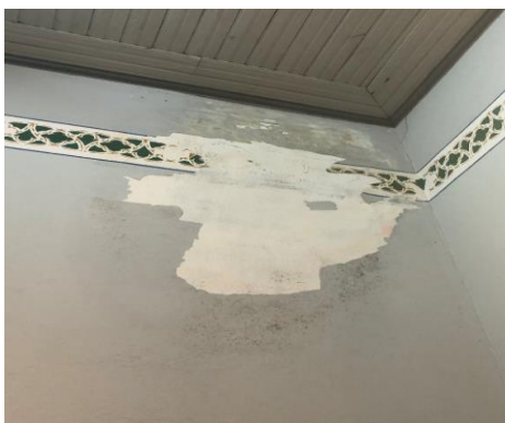
Imagem 5: Avaria na pintura devido a umidade na área interna do edifício.
