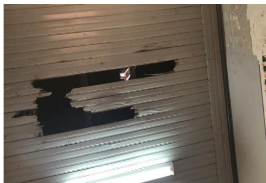
Imagem 3: Abertura no forro de madeira na área interna do edifício.
