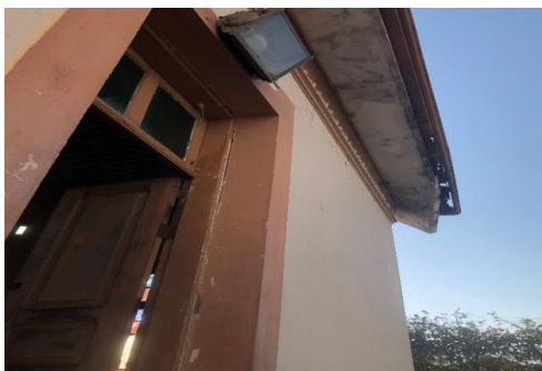
Imagem 4: Flecha excessiva da laje superior do edifício na área externa.
