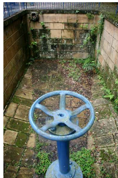
Interior das caixas d'água. 08/2006.
