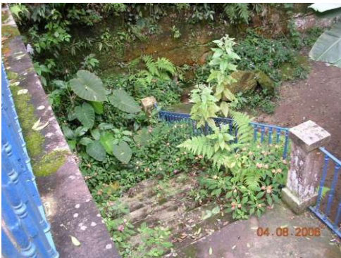
Mato na escada de acesso. 08/2006.
