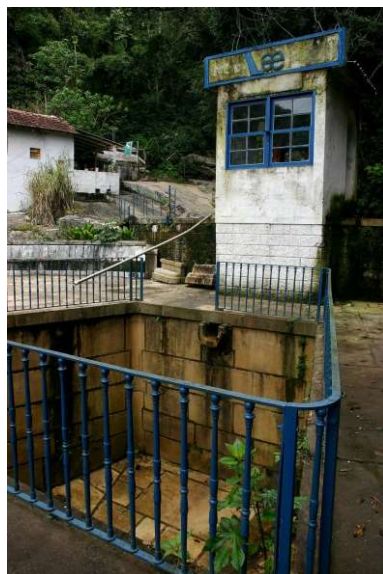
Infiltrações no posto de tratamento. 08/2006.
