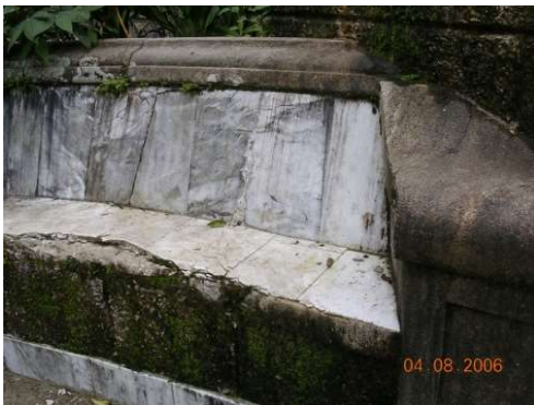
Revestimento do banco danificado. 08/2006.
