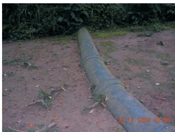
Duto no Reservatório.
